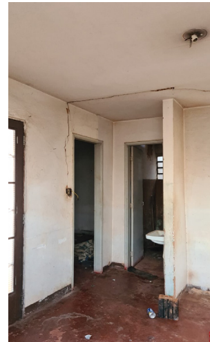
FOTO 04 Fissura e acúmulo de lixo no interior da edificação
