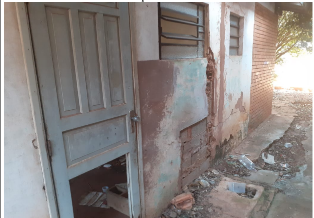
FOTO 02 Edificação em ruínas
