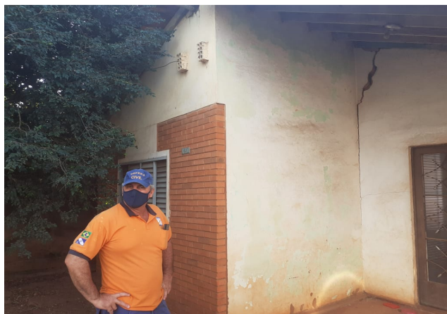
FOTO 03 Fissura no oitão.
