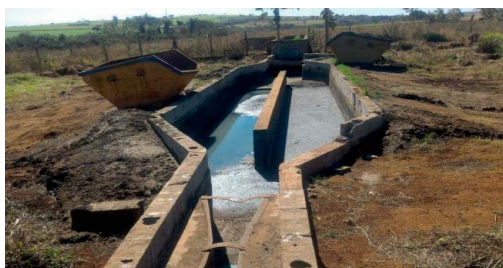
Foto 3.47 – Tratamento preliminar (Gradeamento e caixa de areia) e Calha Parshall
