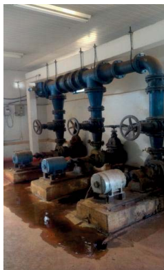
Foto 3.39 – Estação Elevatória – Estação Central
