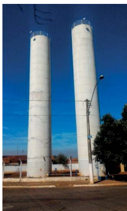
Foto 3.29 – Reservatórios Antônio José Abrahão – R1 e R2
