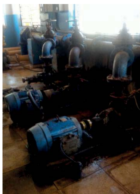
Foto 3.11 – Sistema de bombeamento
