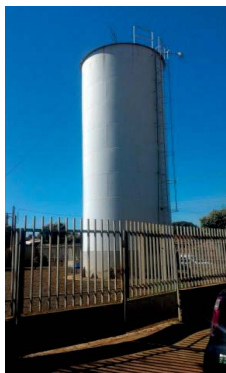
Foto 3.35 – Reservatório Salvador Chapina
