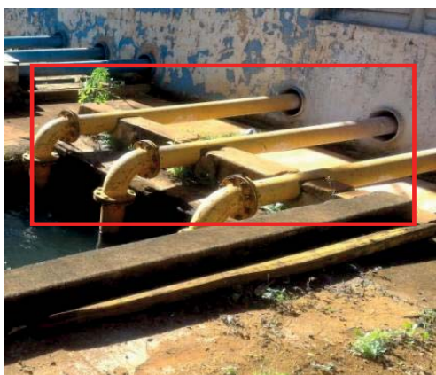
Foto 3.4 – Tubulação de adução de água bruta
