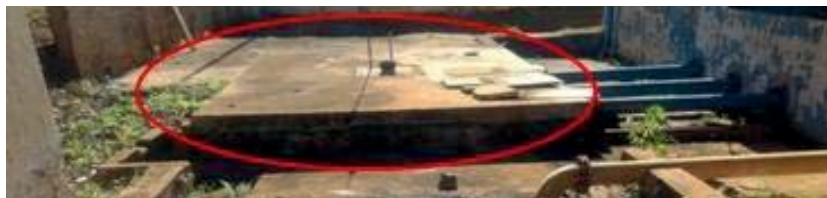
Foto 3.10 – Tanque enterrado de água tratada
