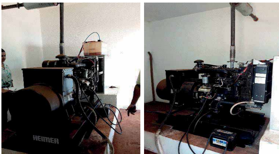
Figura 57 - EEE Jardim Bothanico – Gerador
