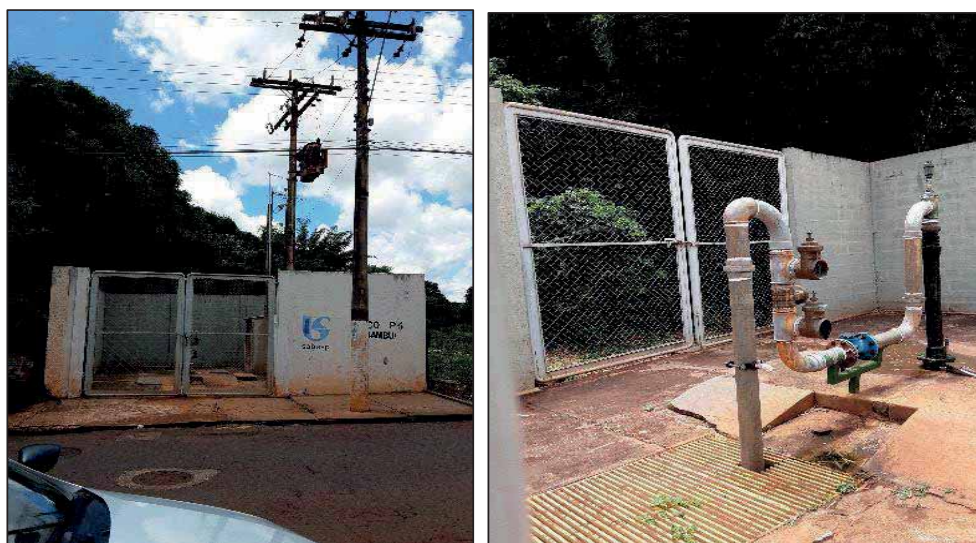
Figura 16 - Captação subterrânea através do Poço 06
