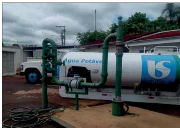
Figura 17 - Captação subterrânea através do Poço 07
