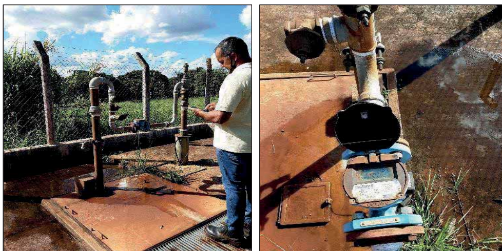
Figura 19 - Captação subterrânea através do Poço Coasa
