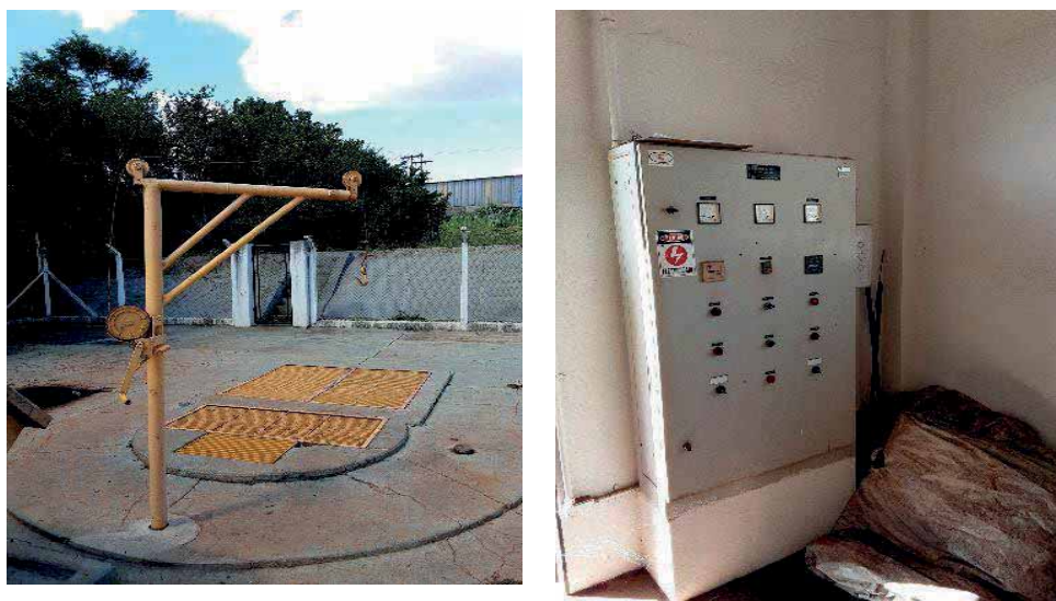
Figura 51 - EEE Nova Igarapava – Bombas submersas e quadro das bombas
