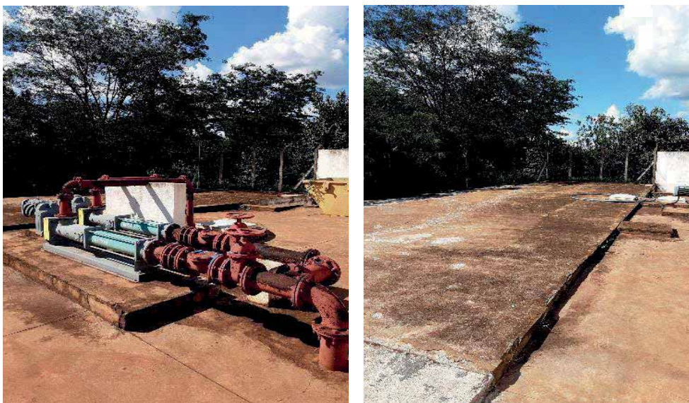
Figura 56 - EEE Jardim Bothanico – Poço Pulmão e Bombas
