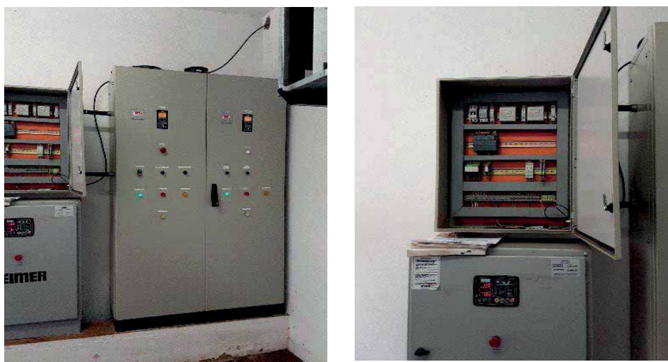
Figura 58 - EEE Jardim Botânico – Quadro elétrico Bombas e sistema de telemetria.
