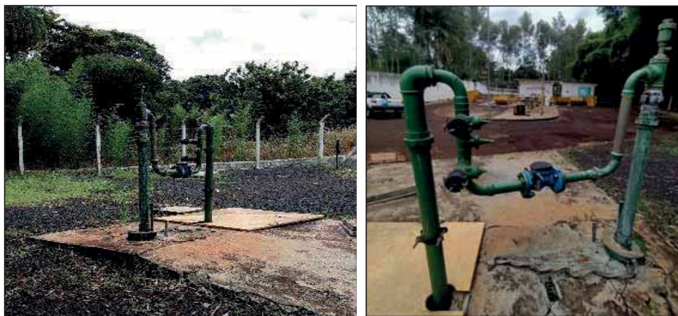
Figura 20 - Captação subterrânea através do Poço 11
