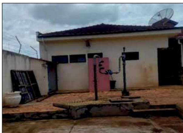
Figura 13 - Captação subterrânea através do Poço 03
