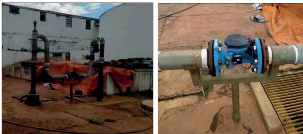
Figura 12 - Captação subterrânea através do Poço 02
