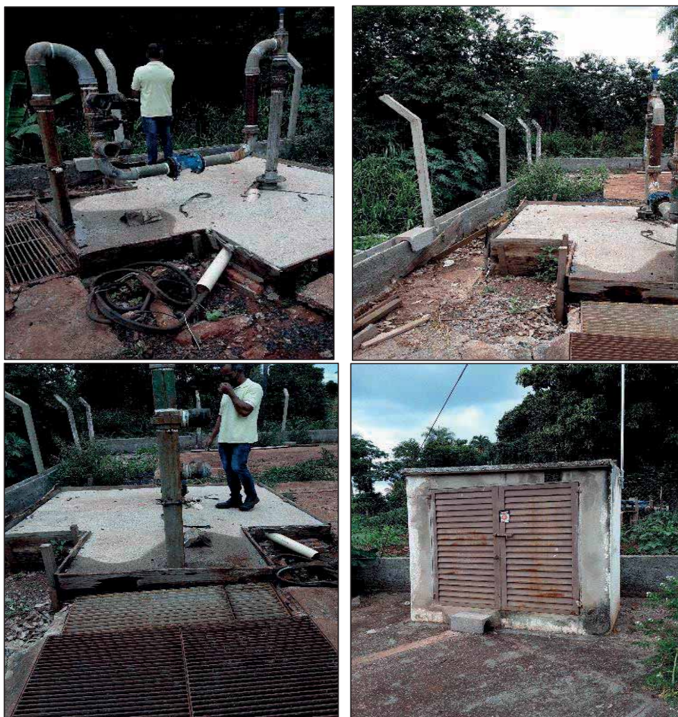
Figura 21- Captação subterrânea através do Poço 12 (Avezum)
