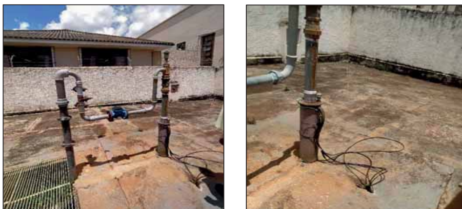
Figura 18 - Captação subterrânea através do Poço 08
