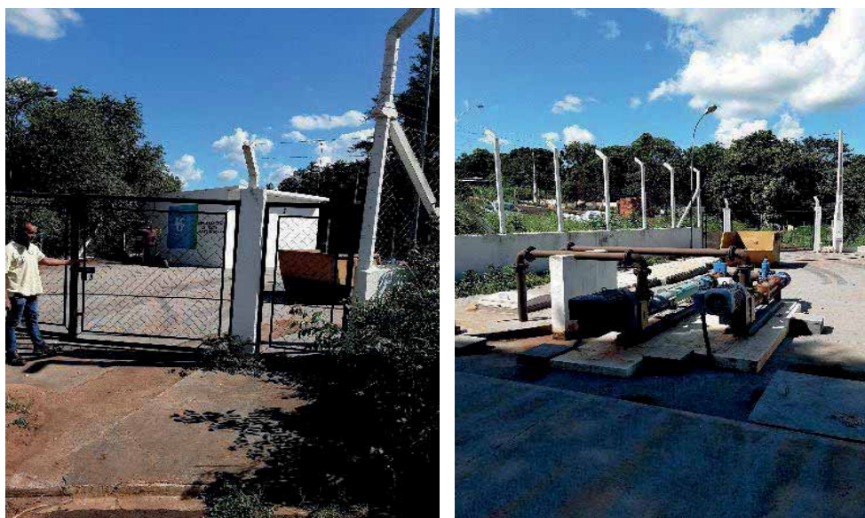
Figura 52 – EEE Recanto dos Pinheiros – Entrada e bombas
