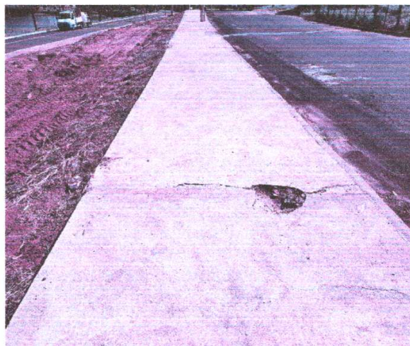
Foto 02 – Buraco no calçamento executado.
