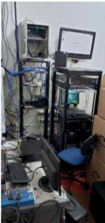
Figura 13: Data Center da PMJ
