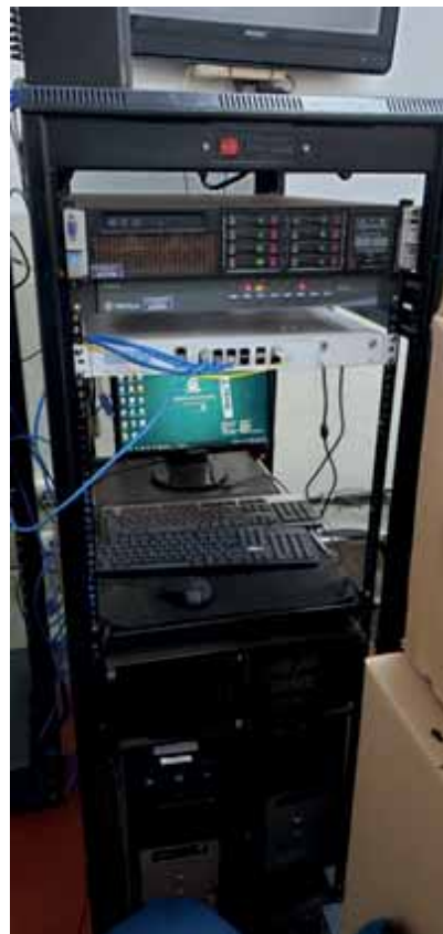
Figura 14: Data Center da PMJ
