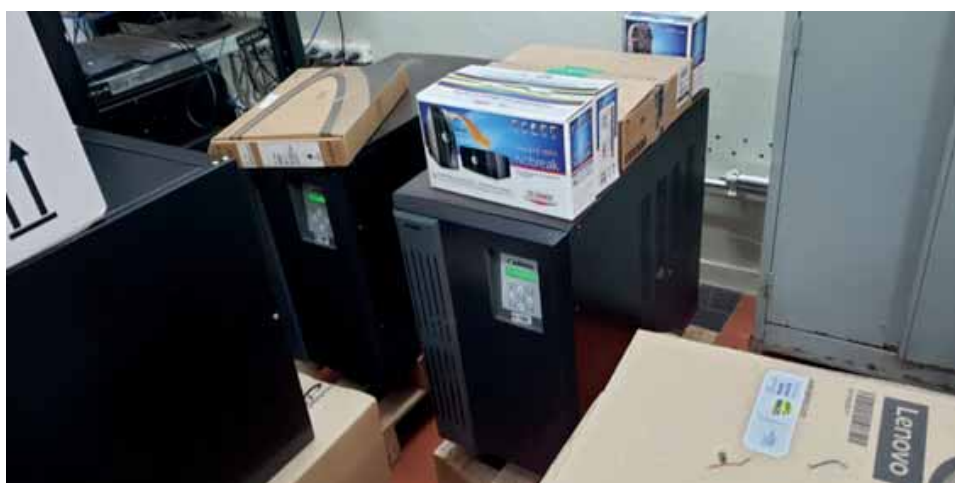
Figura 15: Data Center da PMJ
