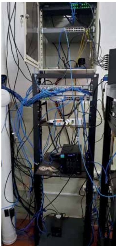
Figura 16: Data Center da PMJ
