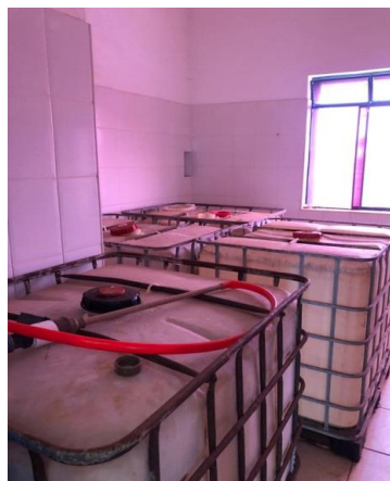
Figura 37: Depósito de produtos químicos da ETA-1
