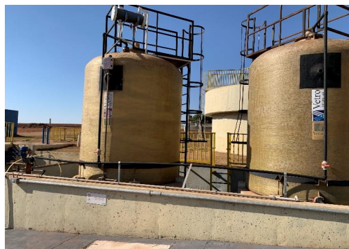
Figura 85: Tanque de produtos químicos
