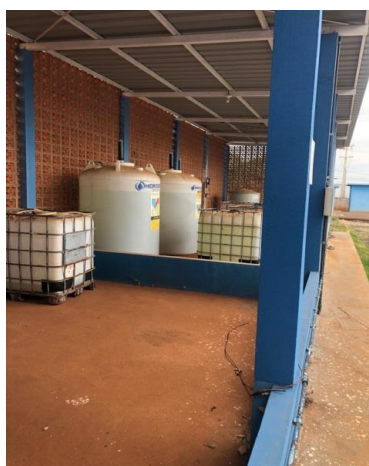
Figura 40: Estocagem de produtos químicos da ETA-1
