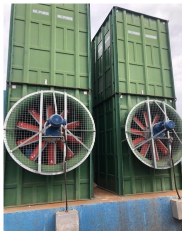
Figura 39: Torres de resfriamento da ETA-1
