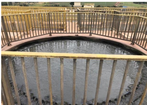
Figura 90: Detalhe dos Reatores Anaeróbios
