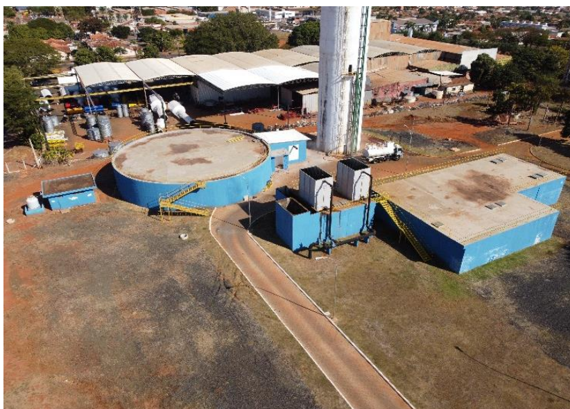
Figura 43: Reservatórios e Torre de Resfriamento
