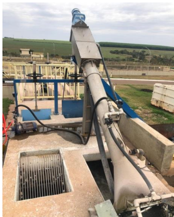
Figura 88: Sistema de Gradeamento
