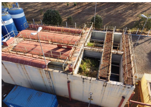
Figura 79: Reator Anaeróbio desativado
