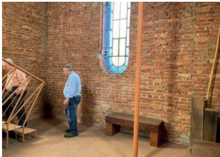
Pedaços das vigas que davam sustentação aos sinos e patamar da escada
