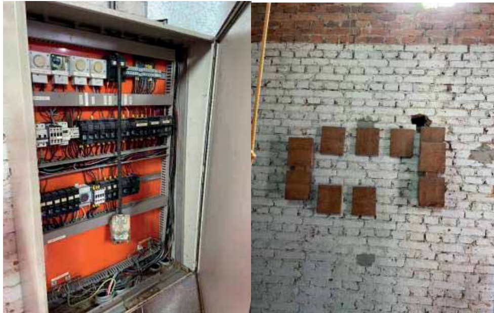
Caixa de Energia
