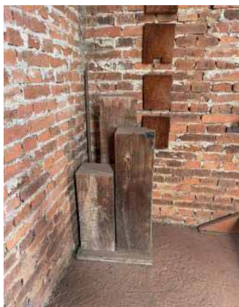
Mais vigas de sustentação dos sinos e detalhe de como ficavam na parede
