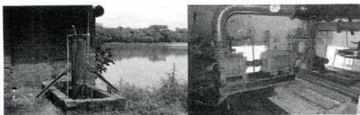
Captação de água bruta da Represa Bom Jesus I – Vista externa parcial da instalação e da área interna.
