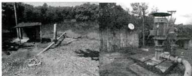
Captação de água bruta da Represa São Jorge I – Vista geral da instalação
