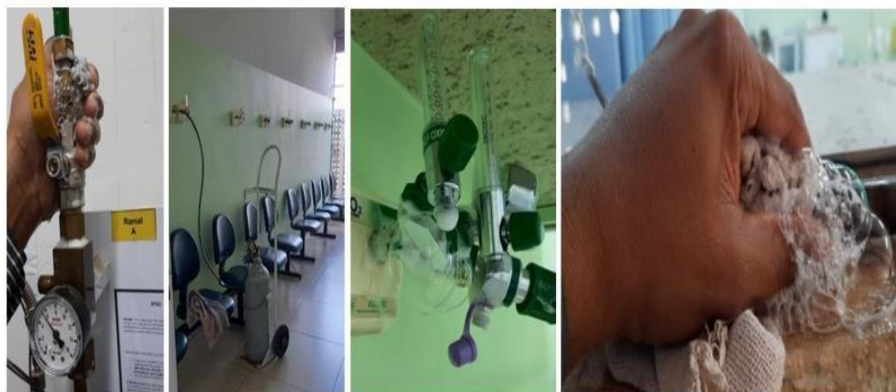
1-VAZAM. NA CENTRAL 2-PRESSURIZAÇÃO R. INALAÇÃO 3-'Y' OBSERVAÇÃO 4-VAZAMENTO SEVERO URGENCIA REDE AMPL.
