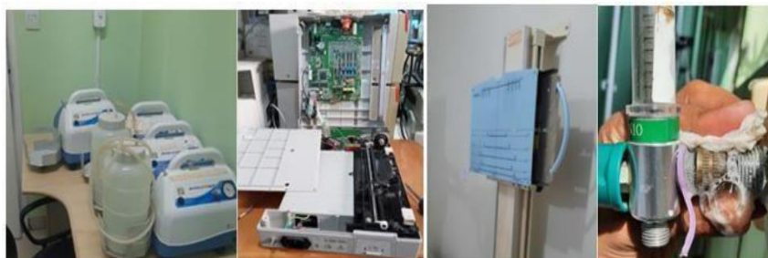
11-ASPIRADORES P/ CONSERTO, 12-REPARO DE ECG URGÊNCIA 13-REPARO BUCK VERT.RX 14-VAZAMENTO O 2 L1
