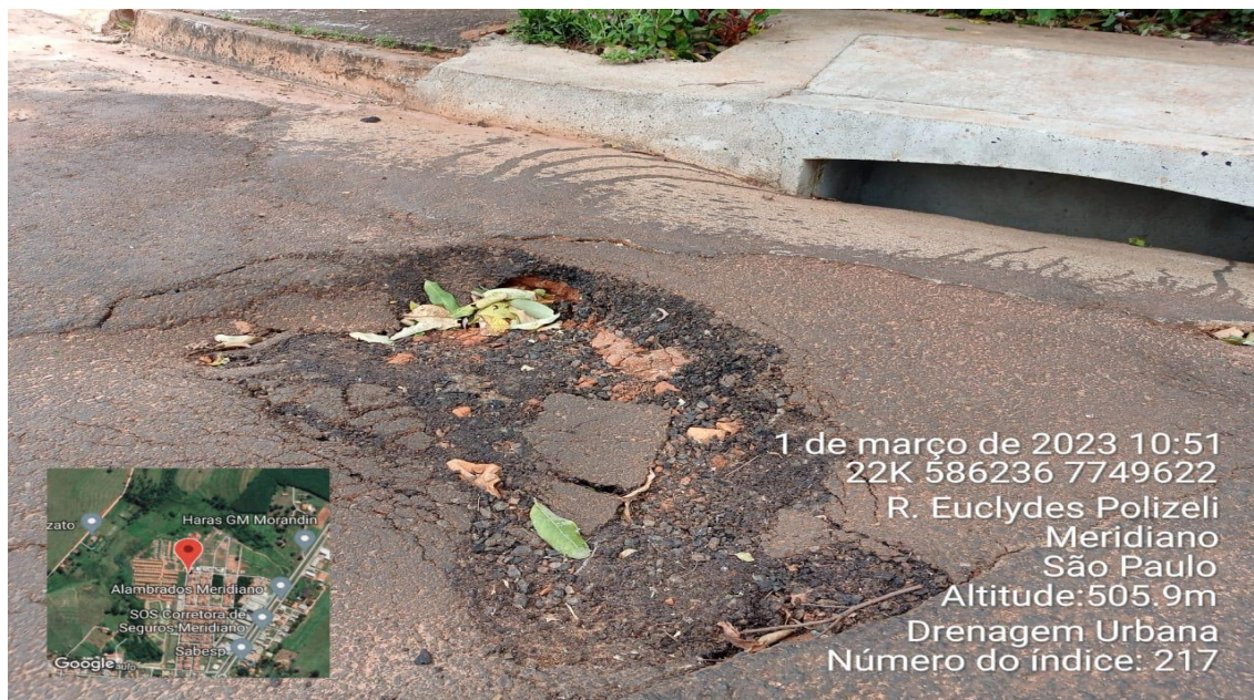
Figura 1: Ruptura e afundamento do asfalto;
