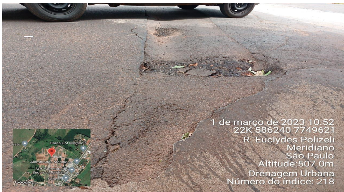
Figura 2: Recalque da vala escavada e asfalto;
