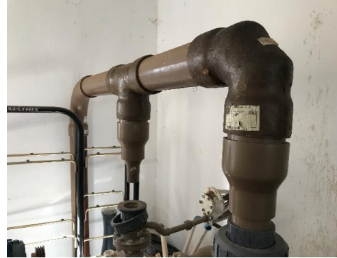
Figura 149. Vista do barrilete de recalque em PVC com acessórios em Fibra de Vidro.
