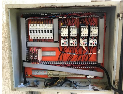
Figura 127. Vista do painel de comando da EEE 05, com partida direta.
