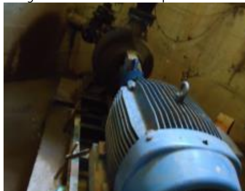
Figura 82. Bomba de Recalque da EEAB 02
