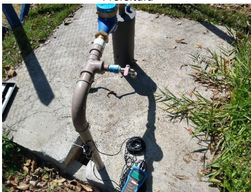
Figura 31. Vista do barrilete do Poço 02 - Prefeitura
