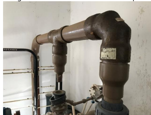
Figura 123. Vista do barrilete de recalque.
