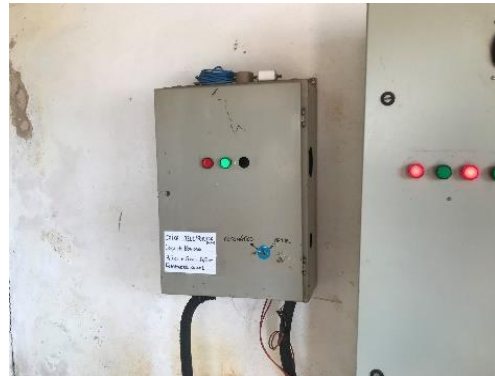
Figura 107. Vista do painel de controle das bombas da EEAT 01.
