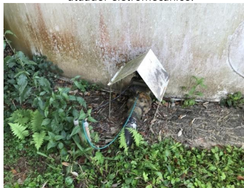
Figura 131. Vista das válvulas borboleta com atuador eletromecânico.
