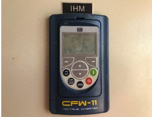
Figura 97. Vista de equipamento – Inversor de Frequência.
