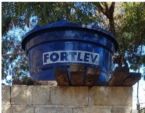
Figura 51. Caixa de água junto ao Poço 06 – Jardim Lindóia
