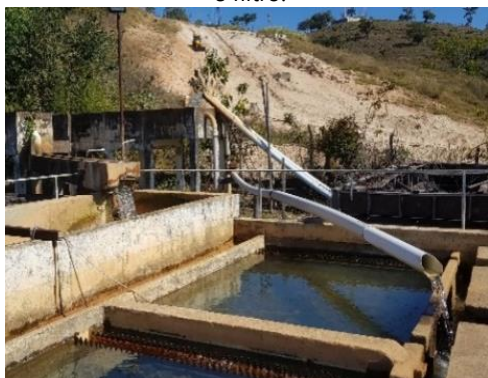
Figura 89. Vista dos decantadores, flocculadores e filtro.
