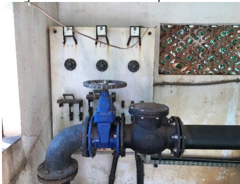
Figura 79. Sistema de Recalque – EEAB 01.
