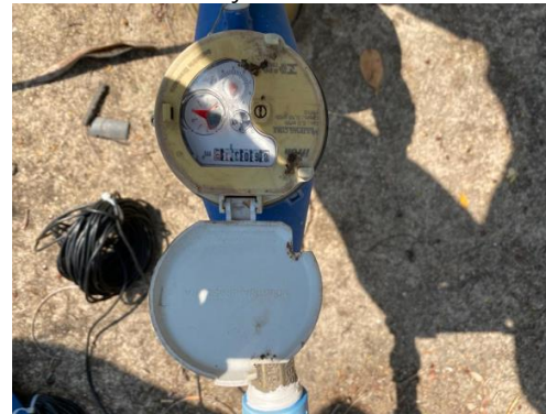
Figura 59. Vista barrilete do Poço P07 – Tijuco Preto
