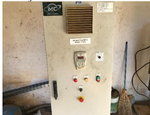
Figura 80. Painel elétrico com IHM.
