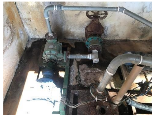
Figura 103. Vista Geral do conjunto motobomba.
