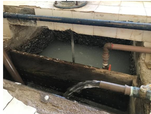
Figura 96. Vista de tanque de adição de químicos.
