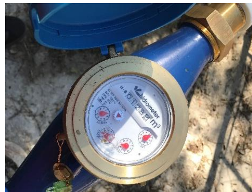
Figura 52. Vista medidor de vazão – Jardim Lindóia
