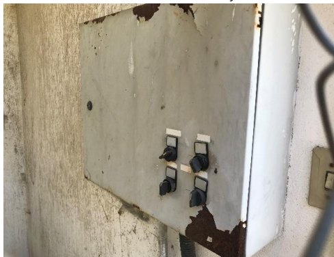
Figura 152. Vista do painel de comando e seu estado de conservação.
