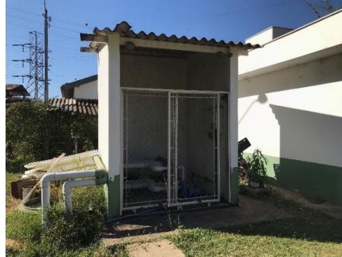
Figura 125. Vista da EEE 05 no tanque pulmão.
