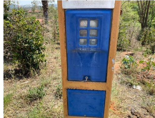
Figura 47. Caixa de Energia do Poço 05 – Parque Aquático
