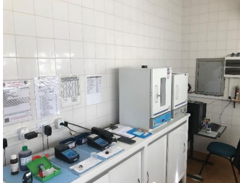
Figura 99. Vista interna do Laboratório da ETA.
