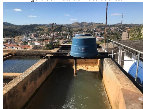
Figura 90. Vista dos Flocculadores.
