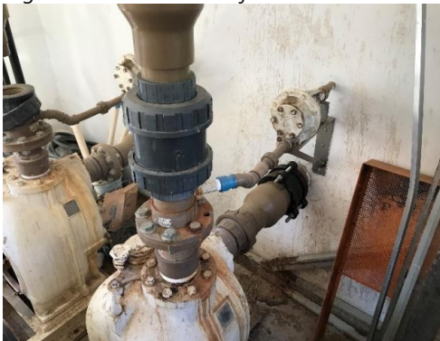
Figura 122. Vista dos conjuntos motor-bomba.
