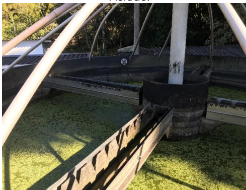
Figura 132. Vista do vertedor do Biofiltro Aerado.
