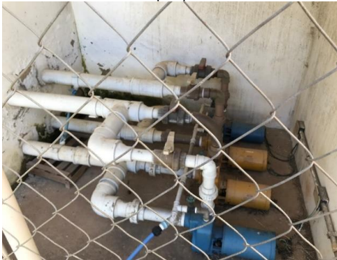
Figura 126. Vista dos conjuntos motor-bomba do tanque pulmão.
