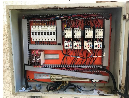
Figura 153. Vista interna do painel de comando e seus componentes.
