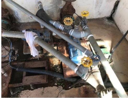
Figura 104. Vista Geral do conjunto motobomba.
