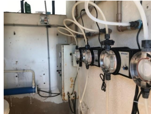
Figura 94. Vista das bombas dosadoras.
