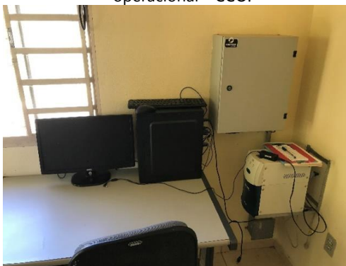
Figura 134. Vista da central de controle operacional - CCO.
