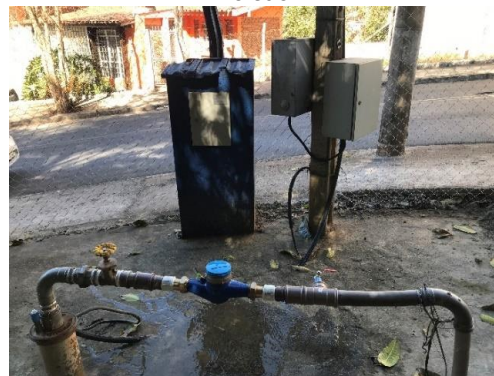
Figura 25. Vista do barrilete do Poço 01 - João Toledo
