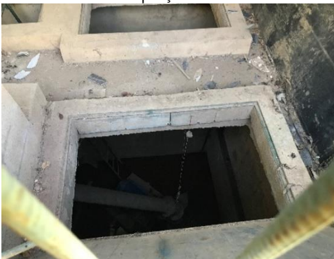
Figura 20. Vista Geral do sistema recalque da captação 02.
