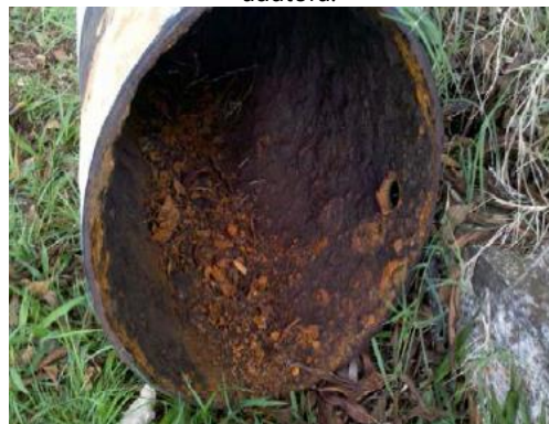
Figura 163. Vista de incrustação em tubulação adutora.
