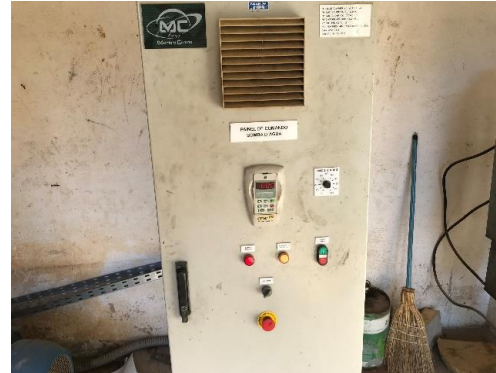
Figura 17. Vista Geral do painel elétrico das bombas.
