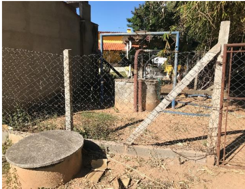
Figura 138. Vista geral da estação elevatória de esgoto 1.
