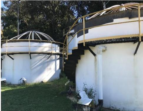
Figura 120. Vista dos Biofiltros Aerados.
