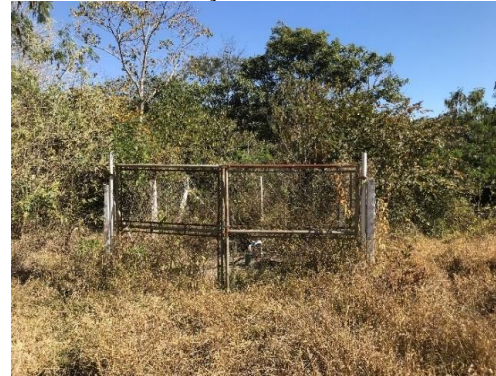
Figura 57. Vista barrilete do Poço P07 – Tijuco Preto
