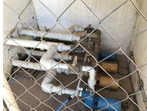
Figura 151. Vista do barrilete e dos conjuntos motor bombas.
