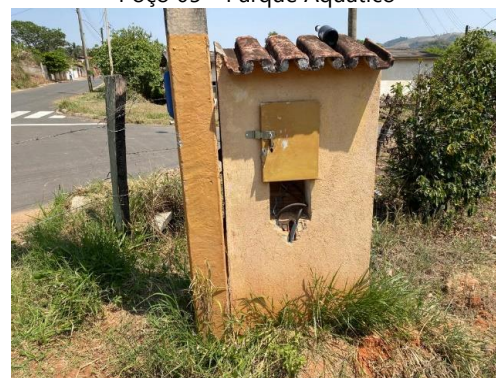
Figura 45. Abrigo do painel de comando do Poço 05 – Parque Aquático
