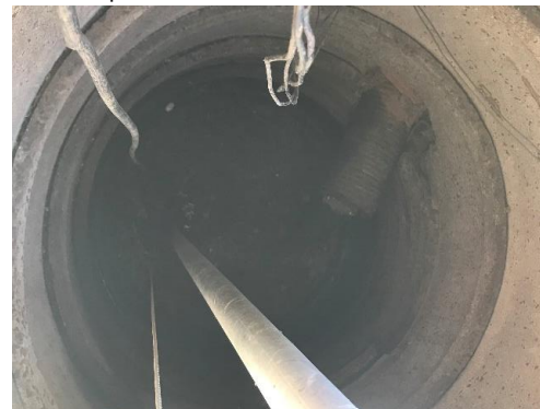
Figura 141. Vista do poço de sucção e do ponto de entrada do efluente.
