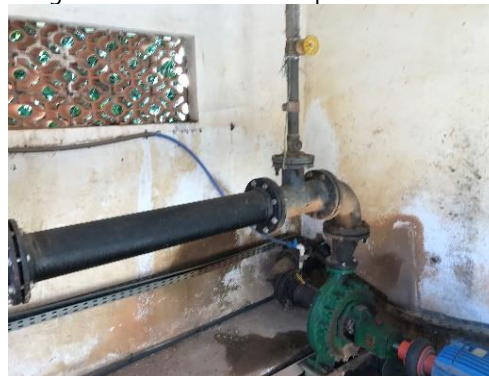
Figura 78. Bomba de Recalque da EEAB 01.
