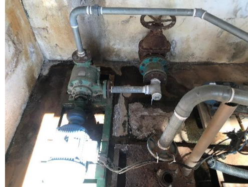
Figura 98. Vista Conjunto Motobomba - Bombeamento para os reservatórios.
