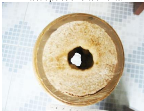
Figura 165. Vista de obstrução severa em tubulação de cimento amianto.
