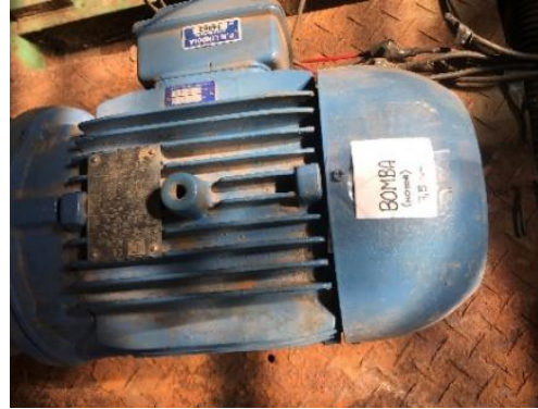
Figura 105. Vista Geral da Bomba de 7,5 cv.
