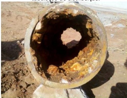
Figura 162. Vista de incrustação moderada em tubulação de distribuição.
