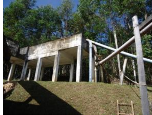
Figura 86. Chegada da Água Bruta na ETA.
