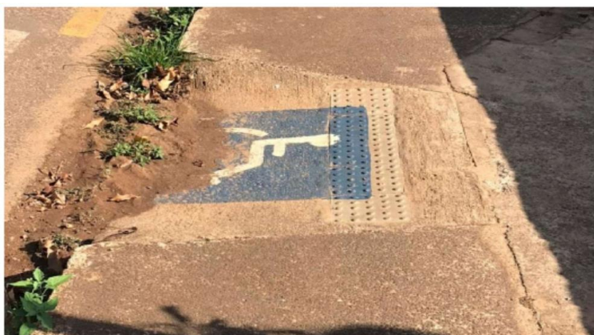
Figura 25 - Falta de manutenção e limpeza
