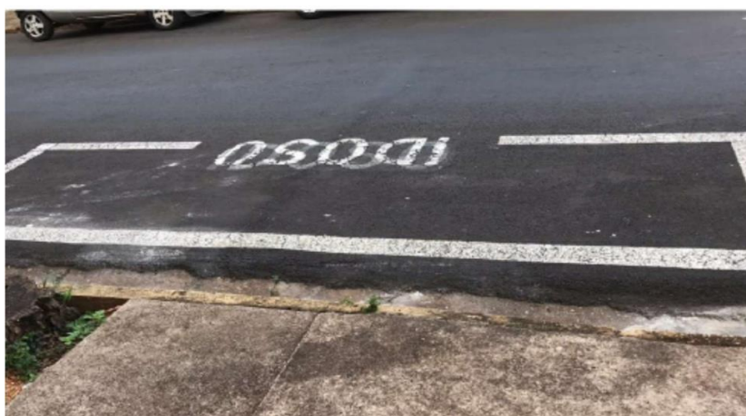
Figura 22 - Falta de padronização nas Vagas de Idosos
