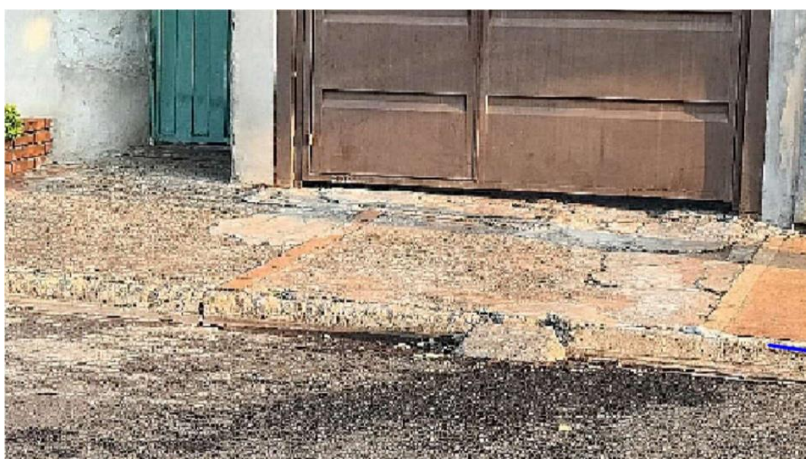
Figura 14 - Calçada com Remendos e Rachaduras
