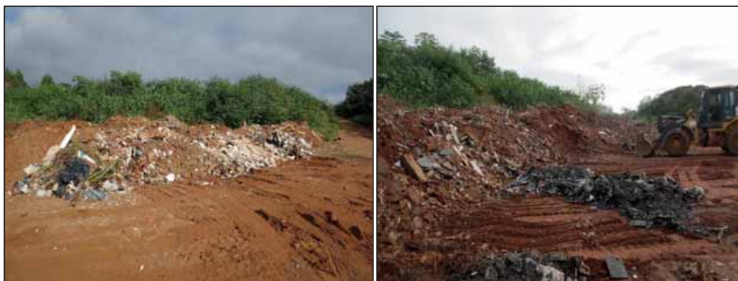
Figura 86 – Entulho depositado na área de destinação de RCC.
