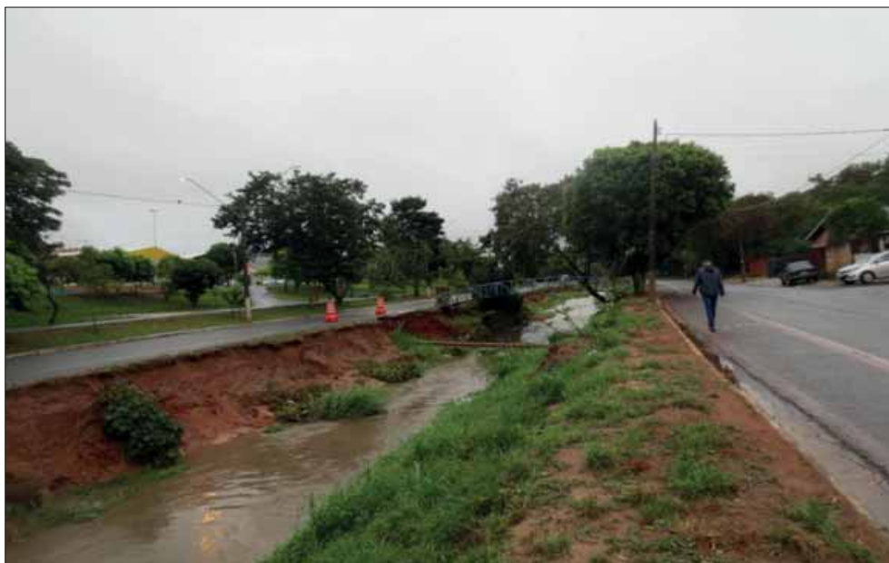
Figura 102 - Registros fotográficos das erosões nas margens do Ribeirão Campestre.
