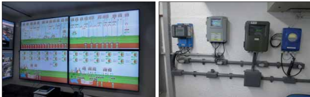
Figura 31 – Centro de controle e operação.
