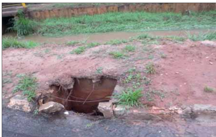
Figura 105 - Dispositivo de microdrenagem com avaria.
