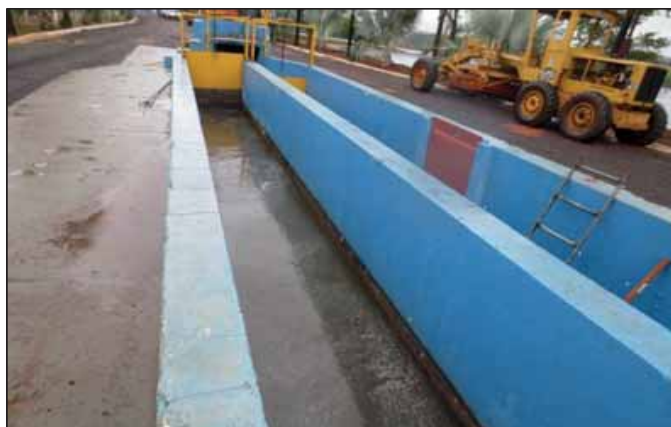
Figura 40 – Caixas de desarenação.
