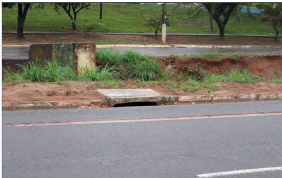
Figura 104 – Microdrenagem no município de Lins.
