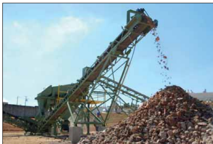
Figura 140 - Usina fixa de RCC.
