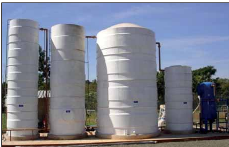
Figura 48 – Estação Compacta de Tratamento de Esgotos Sanitários.
