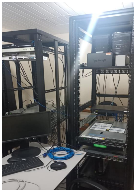
Figura 14: Data Center - PMETO
