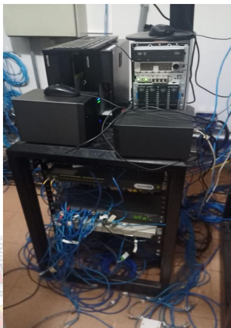
Figura 15: Data Center - PMETO
