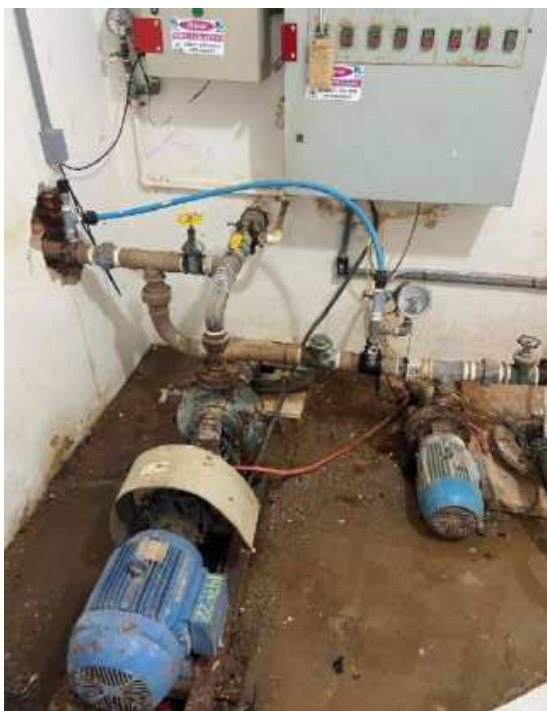
Figura 4-19 – Elevatória de água tratada EEAT-ETA Laras
