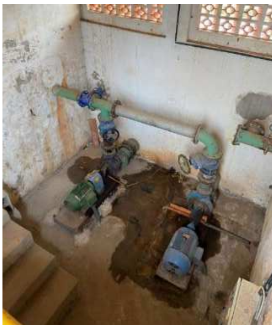
Figura 4-18 – Elevatória de água tratada EEAT-ETA Laras
