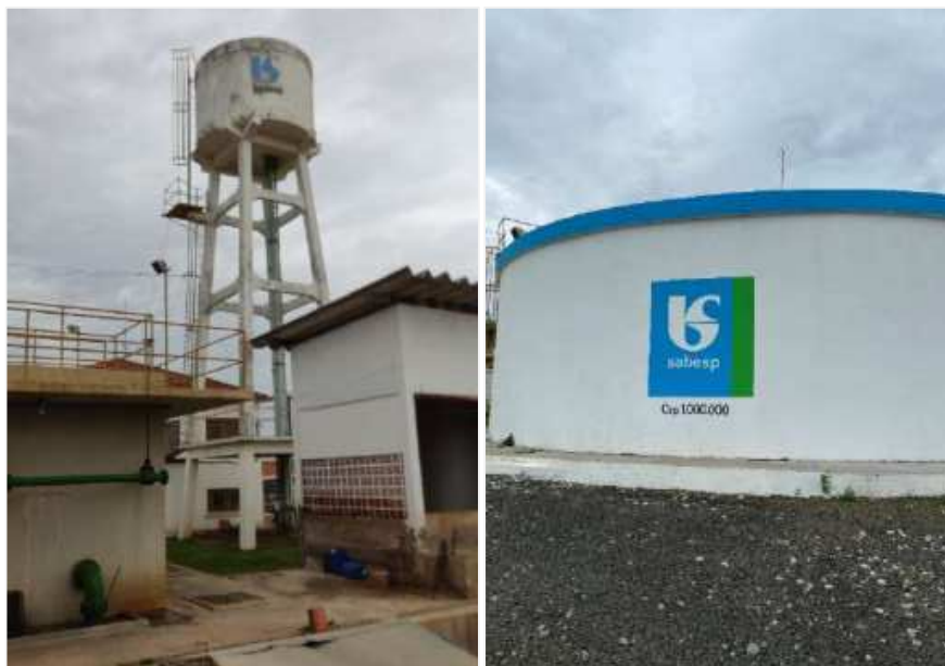
Figura 4-15 – Reservatórios de 50 m³ e 1000 m³ localizados na ETA Laranjal Paulista
