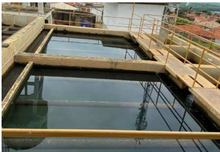
Figura 4-10 – Decantadores da ETA Laranjal Paulista/SP
