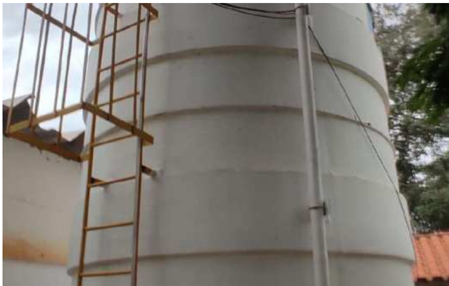
Figura 4-17 – Reservatórios de 30 m³ localizados na ETA Laras
