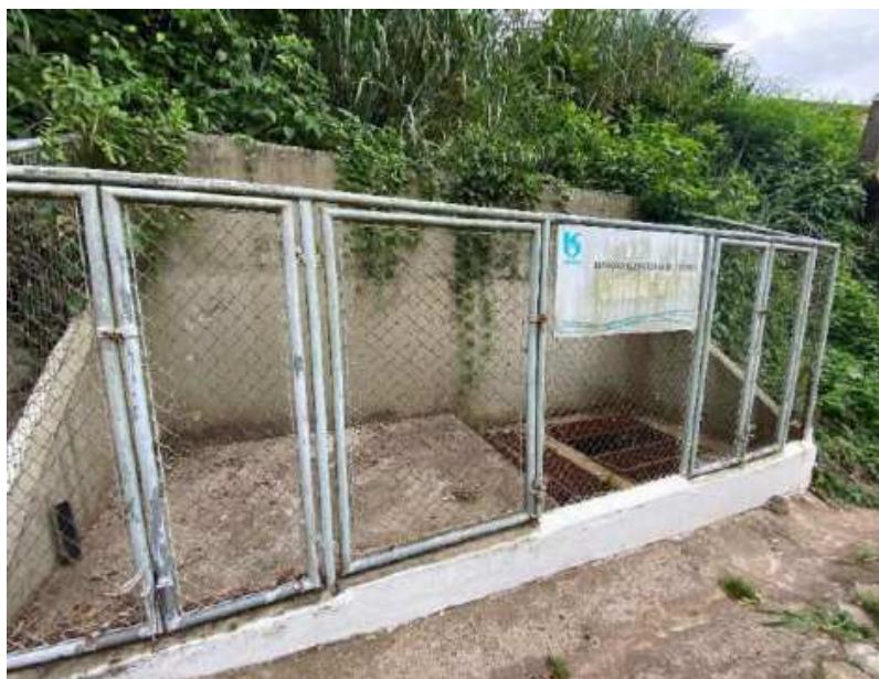
Figura 5-4 – EEE FINAL ETE Laras.
