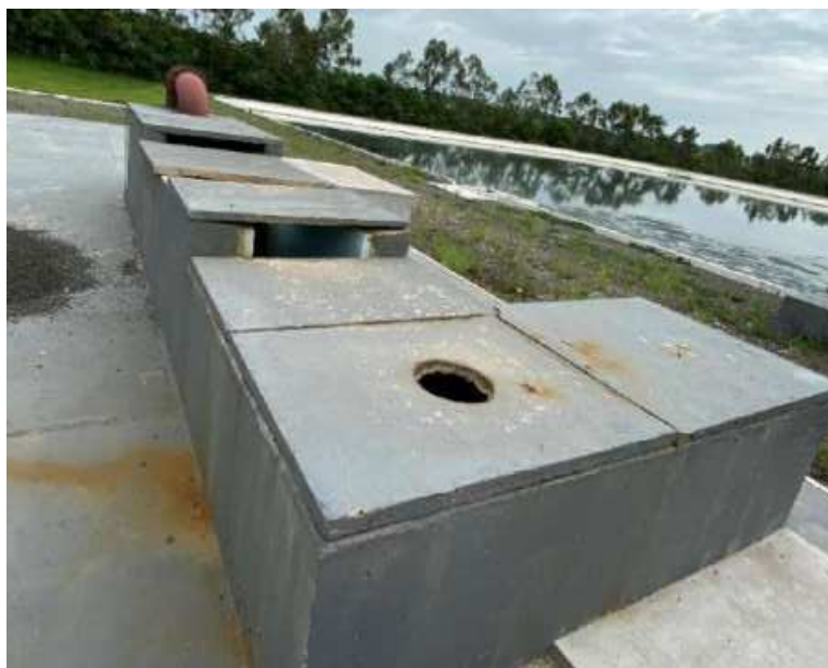
Figura 5-5 – Gradeamento, caixa de areia e calha parshall ETE Sede de Laranjal Paulista/SP.
