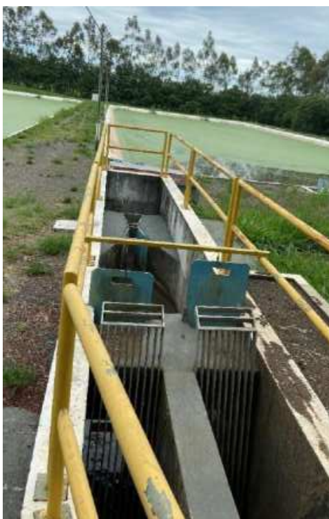
Figura 5-10 – Gradeamento, caixa de areia e calha parshall ETE Laras
