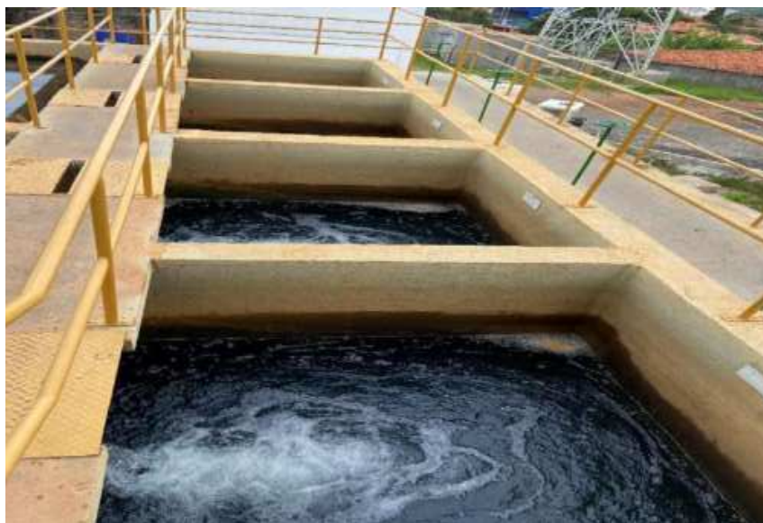
Figura 4-11 – Filtros descendentes da ETA Laranjal Paulista
