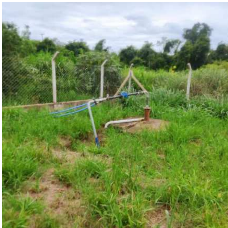
Figura 4-5 – Captação da água bruta no poço P2 do distrito de Laras
