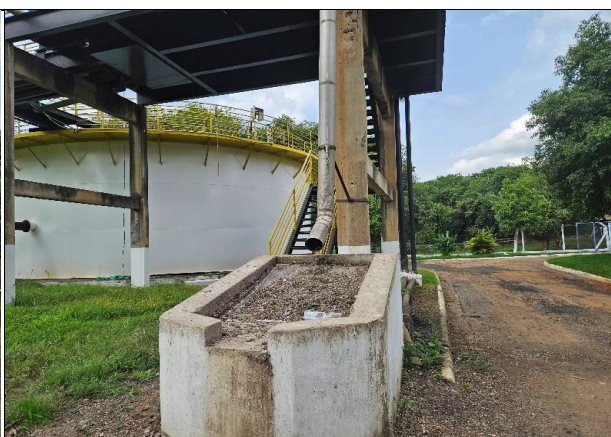
Foto 10: Tubulação desáida dos resíduos sólidos grosseiros removidos pela peneira rotativa da ETE do Distrito Sede (25/10/2023).
