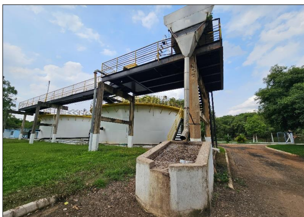
Foto 9: Estação de tratamento de esgoto - ETE do Distrito Sede (25/10/2023).
