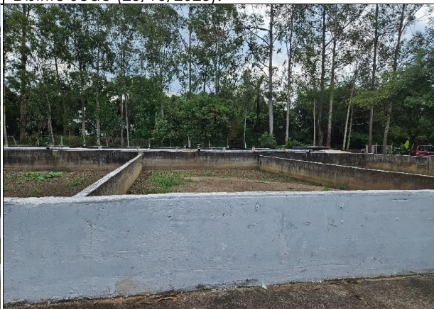
Foto 12: Leito de secagem de lodo da ETE do Distrito Sede (25/10/2023).
