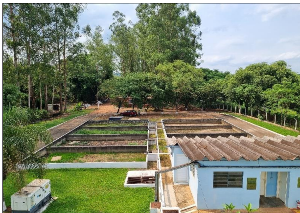
Foto 21: Estação de tratamento de esgoto - ETE do Distrito Sede – destaque para os leitos de secagem de lodo (25/10/2023).
