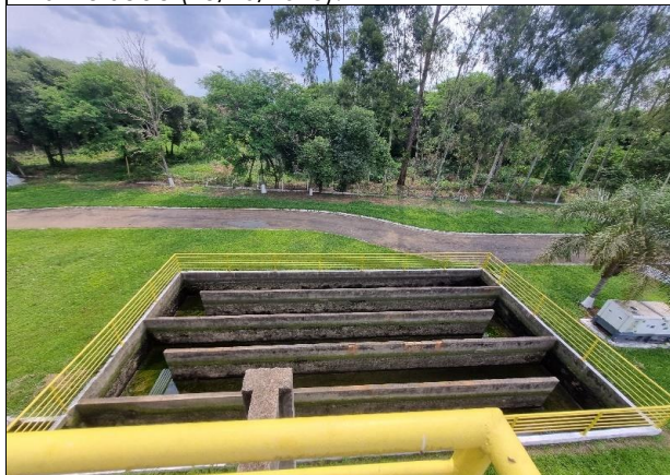
Foto 15: Estação de tratamento de esgoto - ETE do Distrito Sede (25/10/2023).
