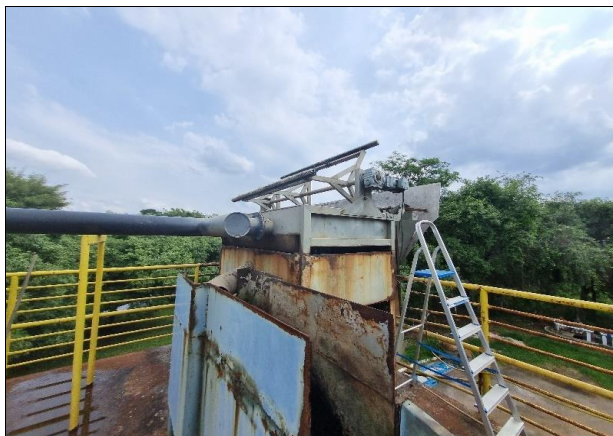
Foto 13: Estação de tratamento de esgoto - ETE do Distrito Sede (25/10/2023).
