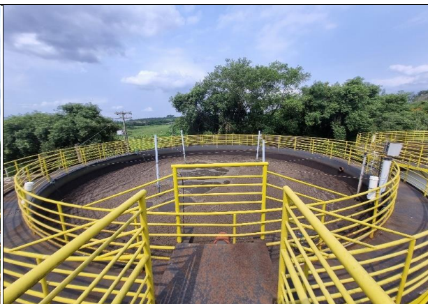
Foto 14: Estação de tratamento de esgoto - ETE do Distrito Sede (25/10/2023).
