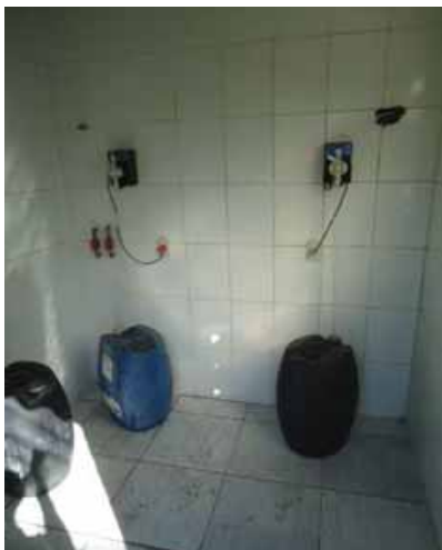
Foto 3.12- Unidade de Fluoretação e Cloração com bomba dosadora – Sistema Centro de Lazer – P5
