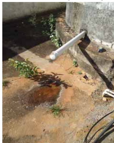
Foto 6.4 – R-06 – Vazamento no registro
