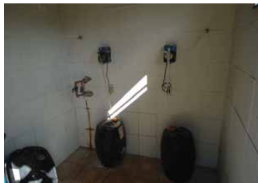
Foto 3.13- Unidade de Fluoretação e Cloração com bomba dosadora – Sistema Creche – P6
