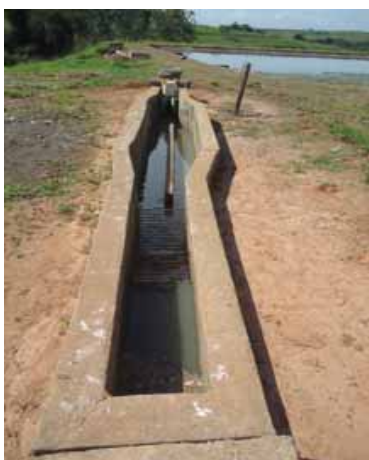
Foto 3.26 – Tratamento Preliminar e Calha Parshall – Entrada ETE
