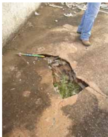
Foto 6.2 – R-06 – Infiltração no calçamento
