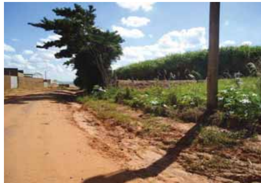
Foto 3.36 – Efeitos da falta de sarjeta
