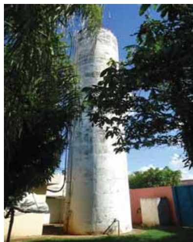
Foto 3.17 – Reservatório 02 (Sist. Centro de Lazer)
