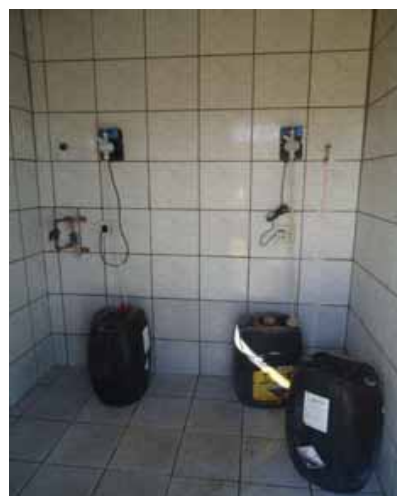
Foto 3.15- Unidade de Fluoretação e Cloração com bomba dosadora – Sistema Velório – P8
