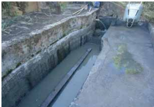
Foto 3.22 – EEE1 - Tratamento Preliminar: Gradeamento e Caixa de Areia
