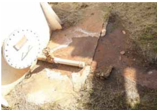
Foto 6.1 – R-01 – Vazamento no registro do ladrão
