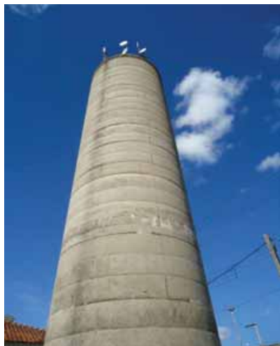
Foto 3.20 – Reservatório 05 (Sist. Velório)
