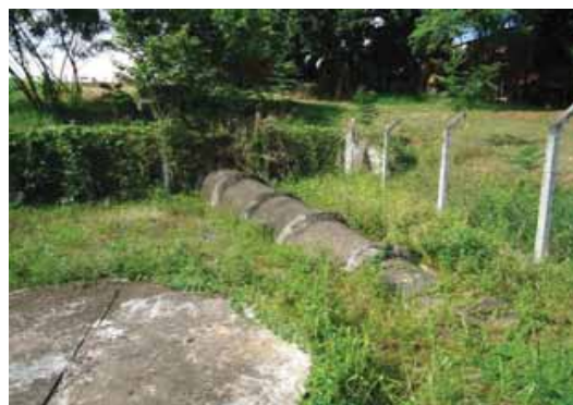
Foto 3.34 – Tubulação que destina a água pluvial para o Córrego das Pedras
