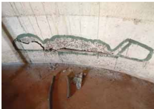
Foto 6.5 – R-06 – Problemas na estrutura do reservatório
