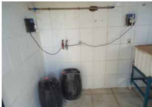
Foto 3.10 – Unidade de Fluoretação e Cloração com bomba dosadora – Sistema Prefeitura – P1, P2 e P3
