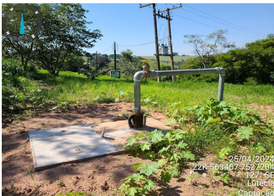
Figura 69 - Captação subterrânea de água
