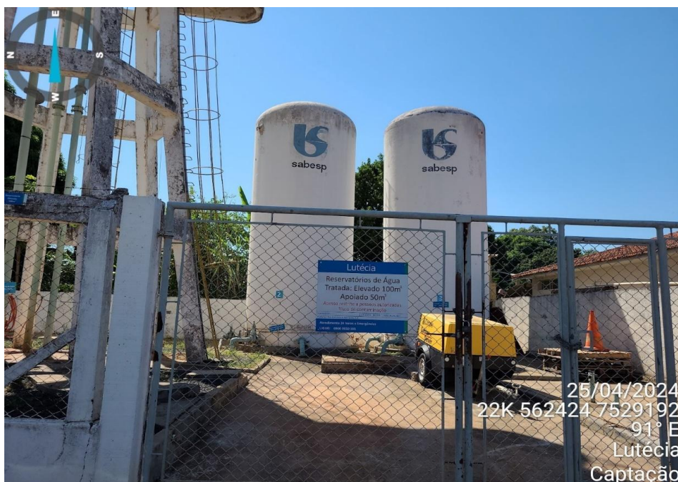
Figura 70 - Reservatórios de Água Tratada
