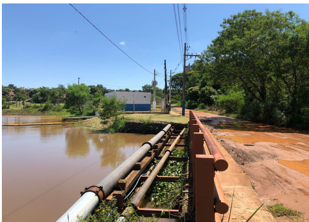
Imagem 22: imagem de montante de captação sofrendo assoreamento e lixiviação.
