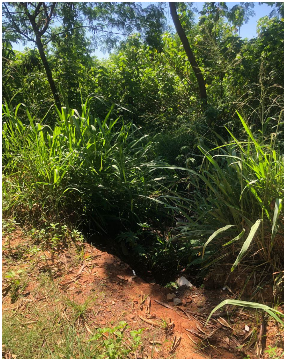
3: imagem de erosão paralela a estrada.
