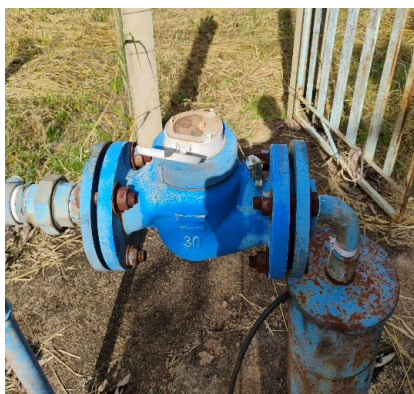
POCO DEL PICOLO - MEDIDOR DE VAZAO
