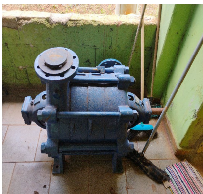
RESERVATORIO R1 - CONJUNTO MOTOBOMBA CENTRIFUGA
