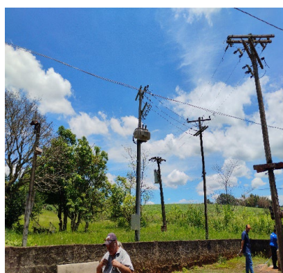
POCO CONTENDAS II - TRANSFORMADOR
