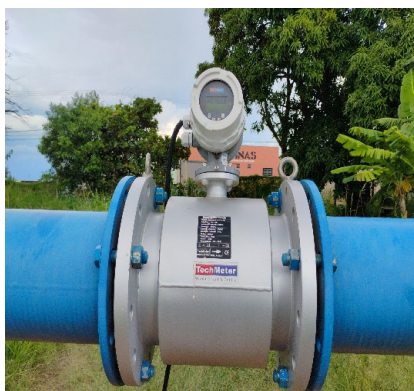
POCO DISTRITO INDUSTRIAL - MEDIDOR DE VAZAO
