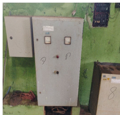
POCO CONTENDAS II - PAINEL ELETRICO
