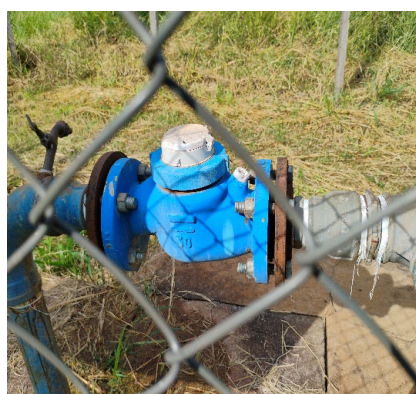
POCO COHAB II - MEDIDOR DE VAZAO
