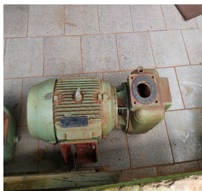
RESERVATORIO R1 - CONJUNTO MOTOBOMBA CENTRIFUGA
