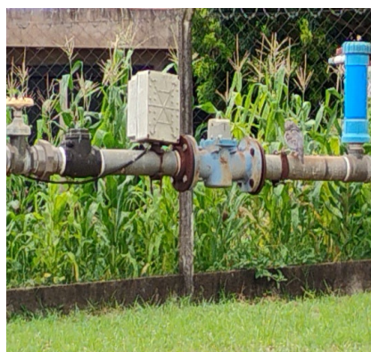
POCO FORTALEZA - MEDIDOR DE VAZAO
