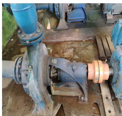
RESERVATORIO R1 - CONJUNTO MOTOBOMBA CENTRIFUGA
