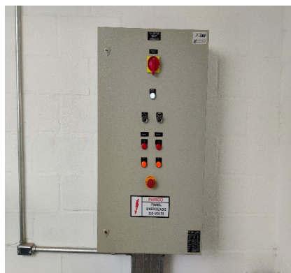
EEE BELAS ARTES II - PAINEL ELETRICO
