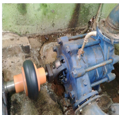
RESERVATORIO R1 - CONJUNTO MOTOBOMBA CENTRIFUGA
