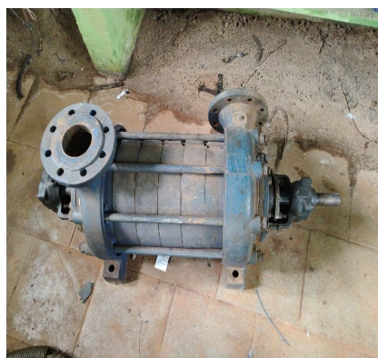
RESERVATORIO R1 - CONJUNTO MOTOBOMBA CENTRIFUGA
