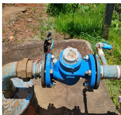
POCO CONTENDAS II - MEDIDOR DE VAZAO
