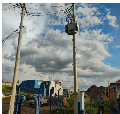
POCO JARDIM MIRANDA - TRANSFORMADOR
