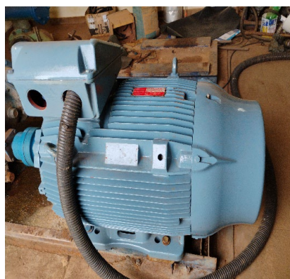
RESERVATORIO R12 - CONJUNTO MOTOBOMBA CENTRIFUGA
