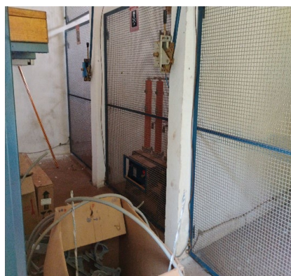
POCO CONTENDAS I - DISJUNTOR GERAL
