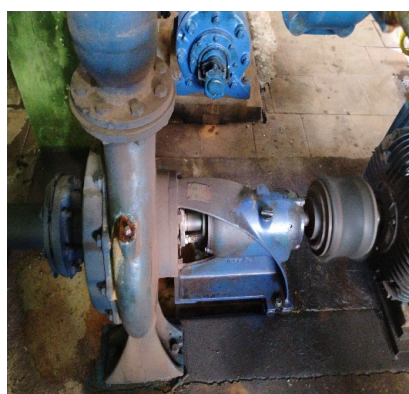
RESERVATORIO R1 - CONJUNTO MOTOBOMBA CENTRIFUGA
