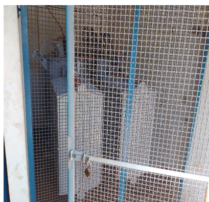
POCO CASA BRANCA - TRANSFORMADOR
