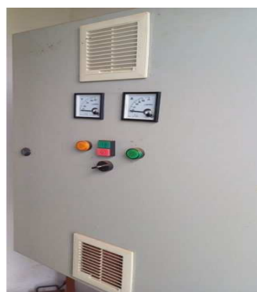
POÇO FORTALEZA – PAINEL ELÉTRICO
