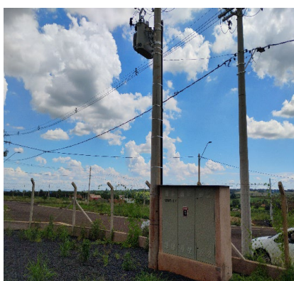
POCO BELAS ARTES - TRANSFORMADOR
