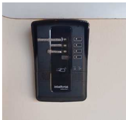
ADM – SUPERINTENDÊNCIA - FECHADURA ELETRÔNICA
