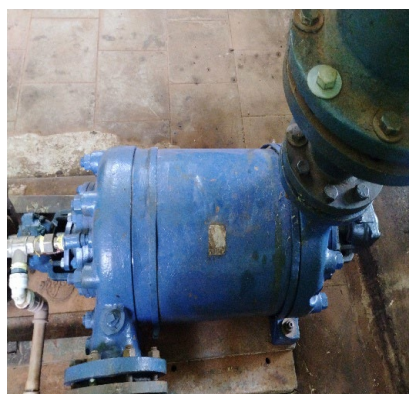
RESERVATORIO R1 - CONJUNTO MOTOBOMBA CENTRIFUGA
