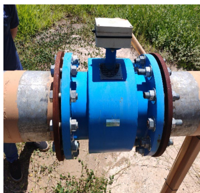
POCO CASA BRANCA - MEDIDOR DE VAZAO
