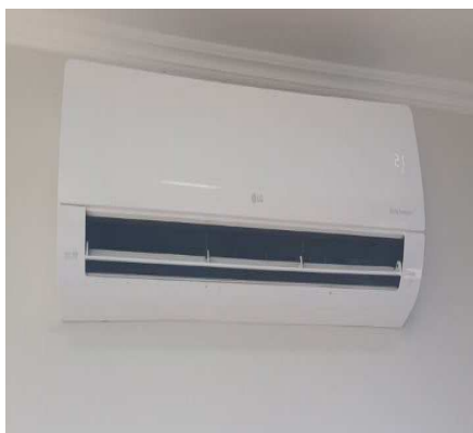
POSTO DE ATENDIMENTO – AR CONDICIONADO
