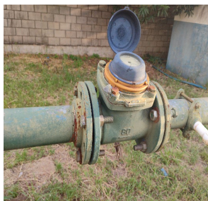
POCO QUEBEC - MEDIDOR DE VAZAO
