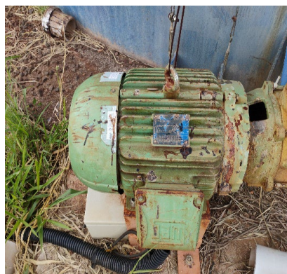
RESERVATORIO R13 - CONJUNTO MOTOBOMBA CENTRIFUGA
