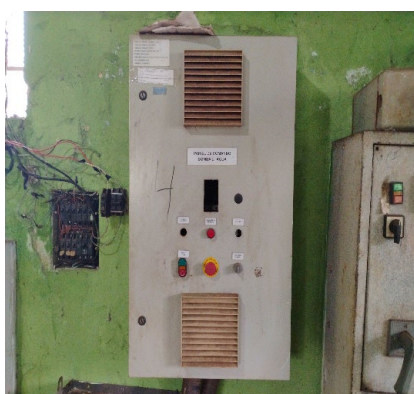
POCO CONTENDAS II - PAINEL ELETRICO
