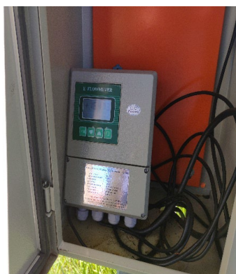
POCO CASA BRANCA - CONVERSOR DE VAZAO
