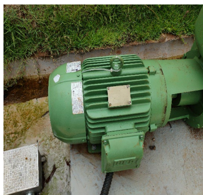
EEE BELAS ARTES II - CONJUNTO MOTOBOMBA CENTRIFUGA
