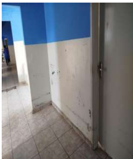
Fig. 15 – Pintura desgastada corredor de passagem varanda
