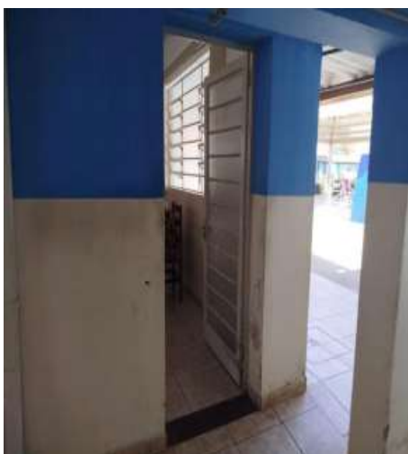
Fig. 21 Pintura desgastada refeitório
