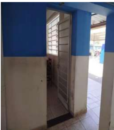
Fig. 22 Pintura desgastada refeitório
