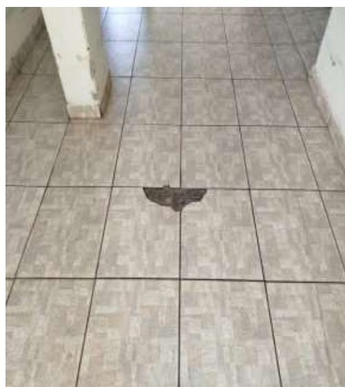
Fig. 14 – Piso área de passagem varanda
