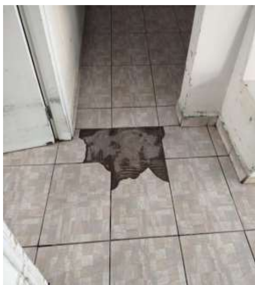
Fig. 13 – Pisos quebrados em vão de passagem
