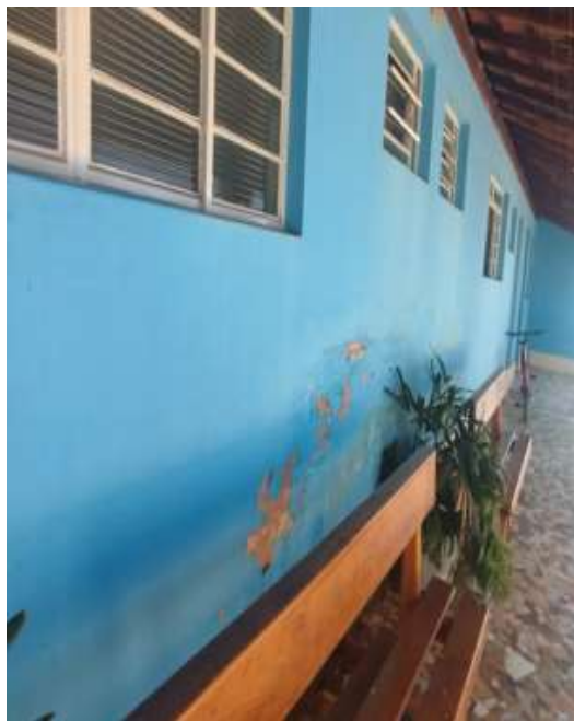
Fig. 11 – Parede dos banheiros da ala feminina voltada para varanda
