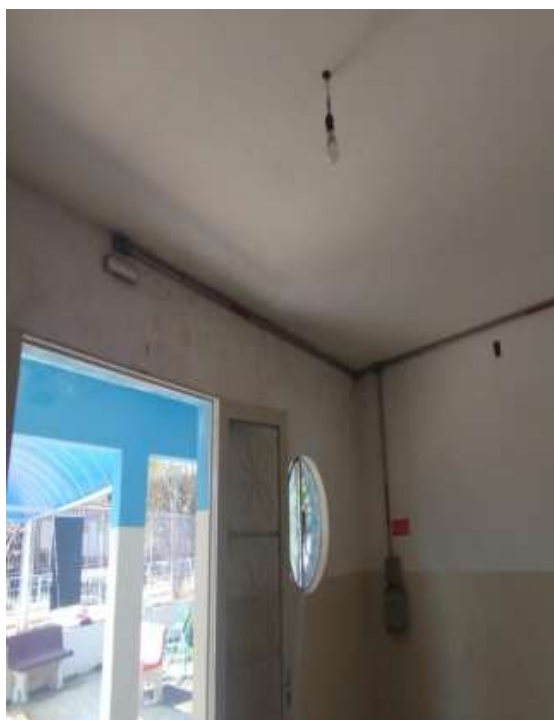
Fig. 7 Infiltração por água de chuva
