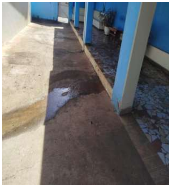
Fig. 24 – Vazamento banheiro ala masculina
