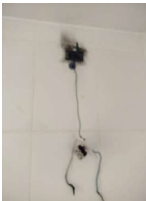
Fig. 32 – Curto circuito rede de chuveiro
