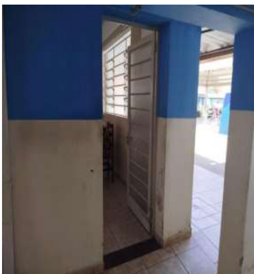
Fig. 19 Pintura desgastada refeitório
