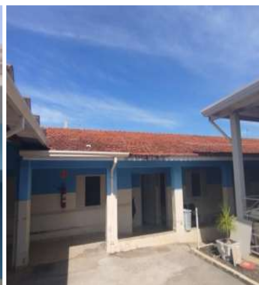
Fig. 10 Infiltração por água de chuva
