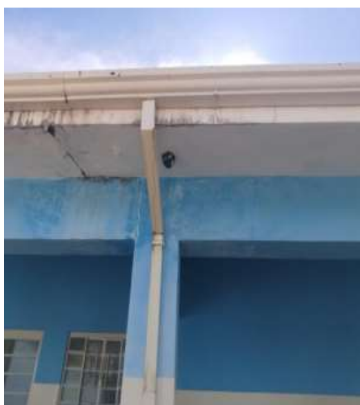
Fig. 9 Infiltração por água de chuva
