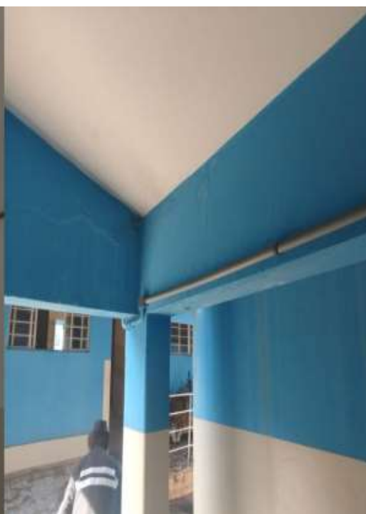
Fig. 8 Infiltração por água de chuva
