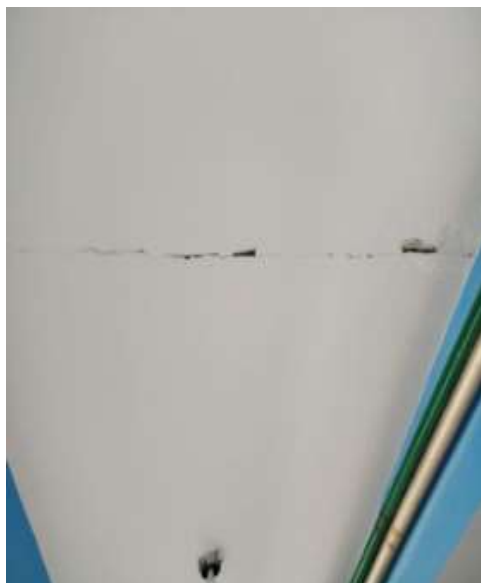
Fig. 4 -Trinca em laje
