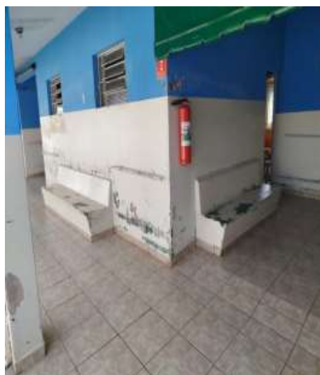
Fig. 20 Pintura desgastada área comum
