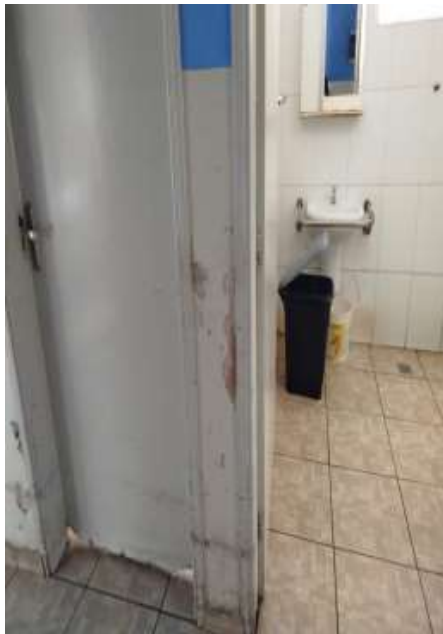
Fig. 18 Pintura desgastada banheiros
