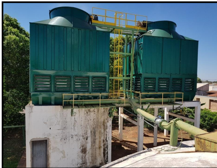
Sistemas isolados de poços profundos Poço Ipanema – 2018
