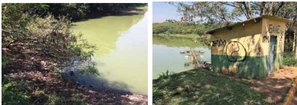
Fotos 9 e 10 – Captação de água bruta da Represa Bom Jesus II – Vista externa da margem esquerda da represa, vendo-se lixo doméstico e externa geral da instalação de captação e recalque, vendo-se o péssimo estado de conservação e sem segurança operacional.
