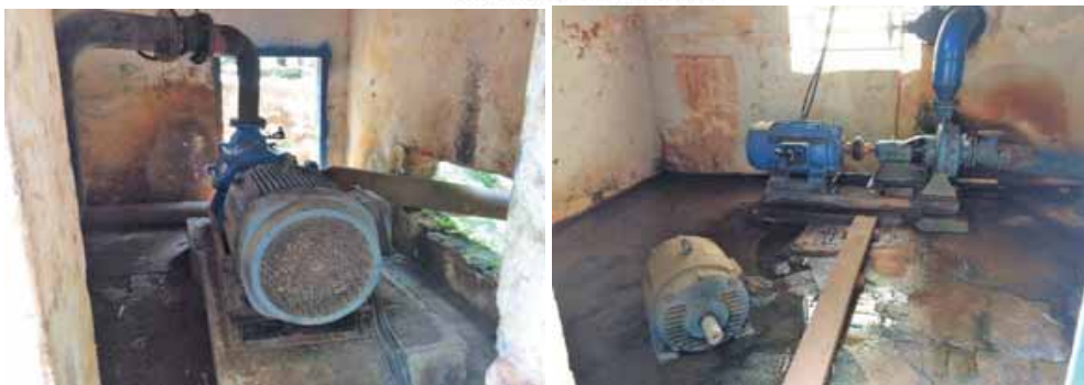
Fotos 5 e 6 – Captação de água bruta da Represa São José Viegas – Vista interna geral da instalação, vendo-se o péssimo estado de conservação e inundações recorrentes.
