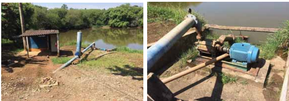
Fotos 7 e 8 – Captação de água bruta da Represa São Jorge I – Vista geral da instalação, vendo-se o estado de conservação ruim e sem segurança operacional.
