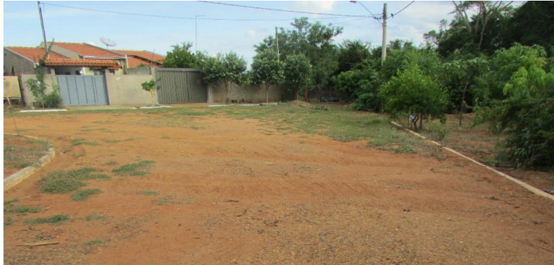
Fotografia 6 – Erosão laminar na Rua dos Lagos (2º ponto)
