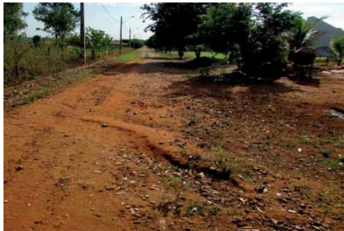
Fotografia 4 – Erosão em sulcos entre a Rua Marajoaras (prolongamento)
