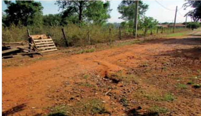
Fotografia 3 – Erosão em sulcos entre a Rua Marajoaras (prolongamento)
