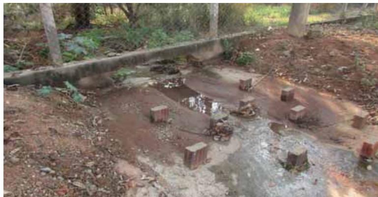
Fotografia 13 – Dissipador de energia de águas pluviais em Área Verde 4 (Quadra 10) no loteamento “Recanto do Sol”
