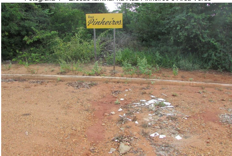
Fotografia 2 – Erosão laminar na Rua Pinheiros e Área Verde
