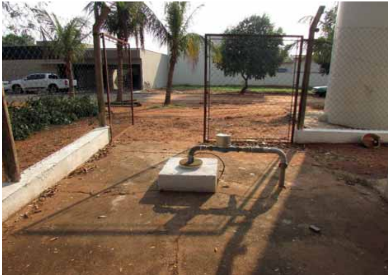
Fotografia 3 – Poço profundo que atende aos loteamentos “Recanto do Sol e Recanto das Águas” localizada em Área Institucional (Lote 02, Quadra 06) do loteamento “Recanto do Sol”
