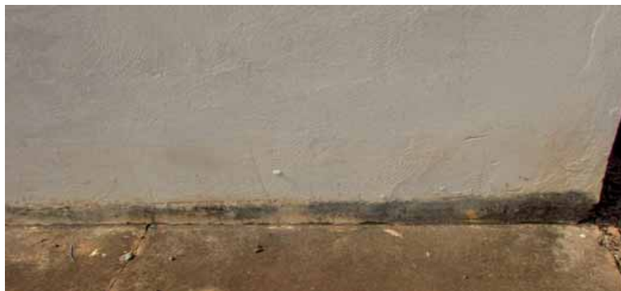
Fotografia 4 – Marcas em muro devido à ocorrência de alagamentos Rua Tupis
