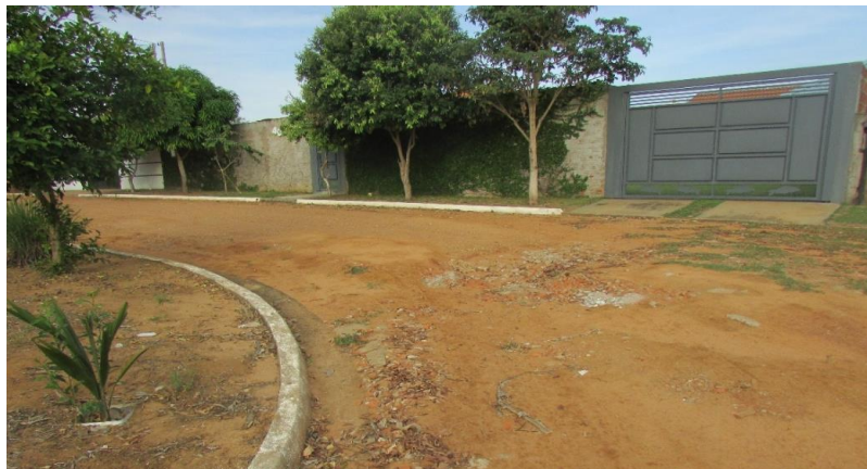
Fotografia 7 – Erosão laminar entre a Rua das Camélias e Rua dos Lagos
