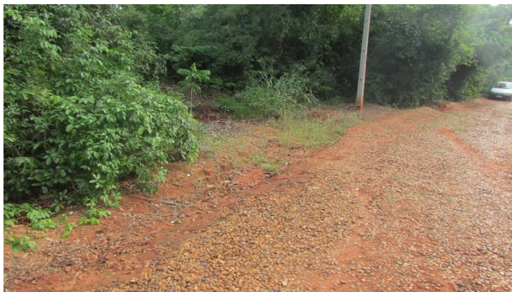
Fotografia 9 – Erosões laminares em diversos pontos na via de acesso à rampa
