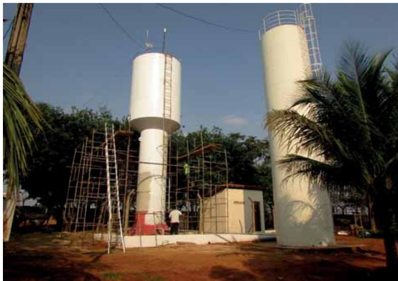
Fotografia 4 – Reservatórios que atendem aos loteamentos “Recanto do Sol e Recanto das Águas” localizada em Área Institucional (Lote 02, Quadra 06) no loteamento “Recanto do Sol”
