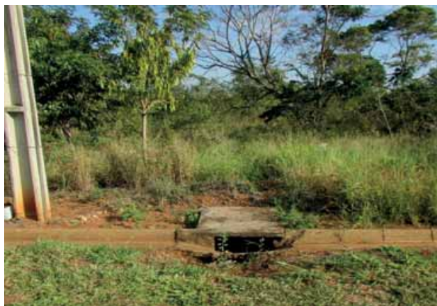
Fotografia 5 – Erosão em caixa coletora de água para bacia de retenção na Rua dos Potiguaras
