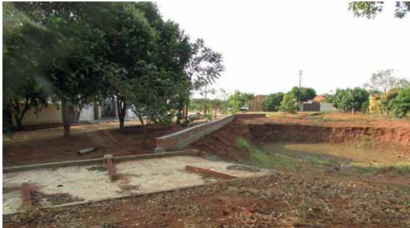
Fotografia 14 – Bacia 01 de contenção/detenção com dissipador de energia em Área Institucional do loteamento “Recanto do Sol” (Lote 31, Quadra 03) interligada a Rua 02
