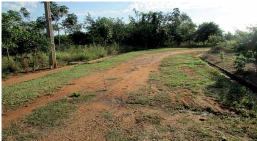
Fotografia 2 – Erosão em sulcos na Rua dos Potiguaras
