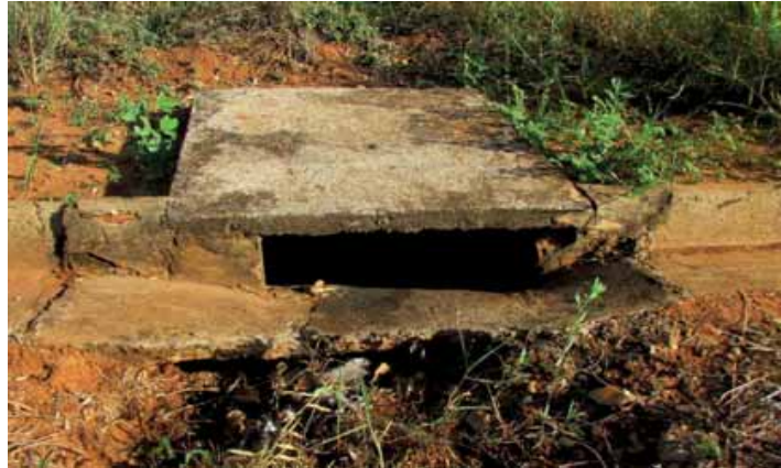
Fotografia 6 – Erosão em caixa coletora de água para bacia de retenção na Rua dos Potiguaras
