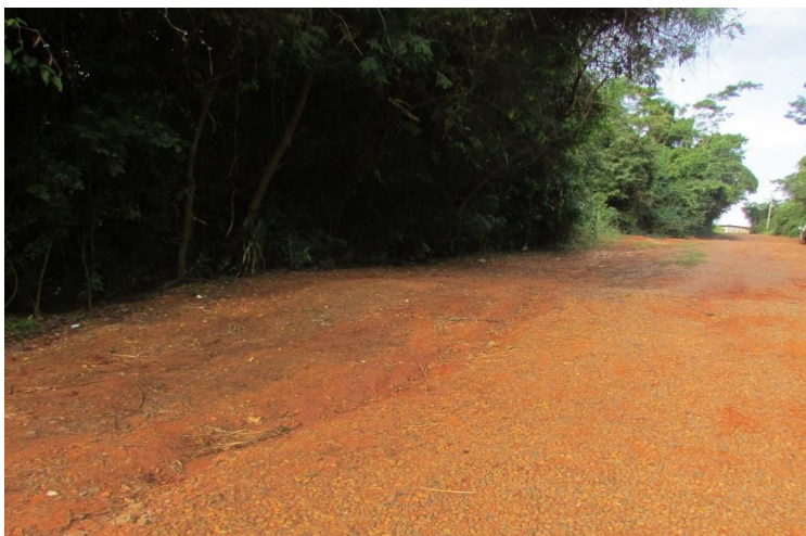
Fotografia 10 – Erosões laminares em diversos pontos na via de acesso à rampa
