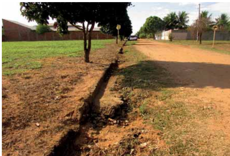
Fotografia 2 – Lotes não demarcados em nenhum terreno e guias e sarjetas quebradas em diversos locais
