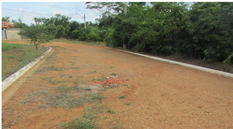
Fotografia 5 – Erosão laminar na Rua dos Lagos (1º ponto)
