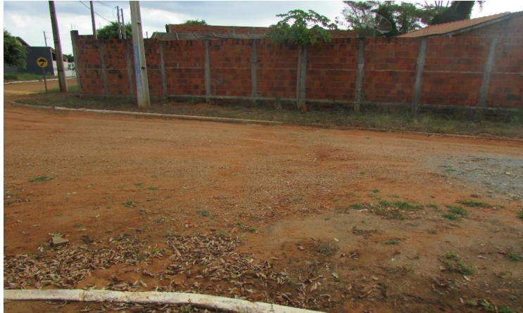
Fotografia 3 – Erosão laminar entre a Rua Pinheiros e a Rua das Orquídeas
