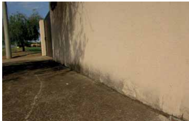
Fotografia 5 – Marcas em muro devido à ocorrência de alagamentos Rua Tupis
