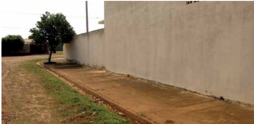
Fotografia 3 – Marcas em muro devido à ocorrência de alagamentos Rua Tupis
