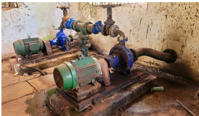
Figura 15: Vista do conjunto motobomba
