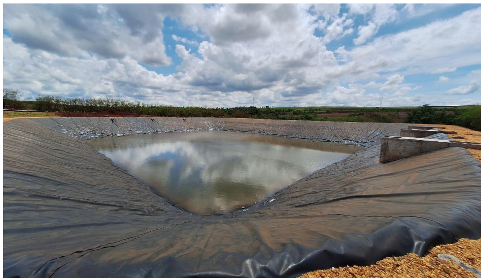
Figura 90: Vista da lagoa cuja obra de implantação foi paralisada, com descolamento das placas de concreto e alastramento de vegetação
