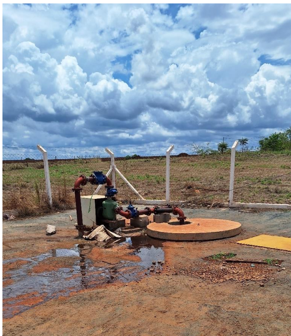
Figura 86 Vista da EEE Santa Lúcia.
