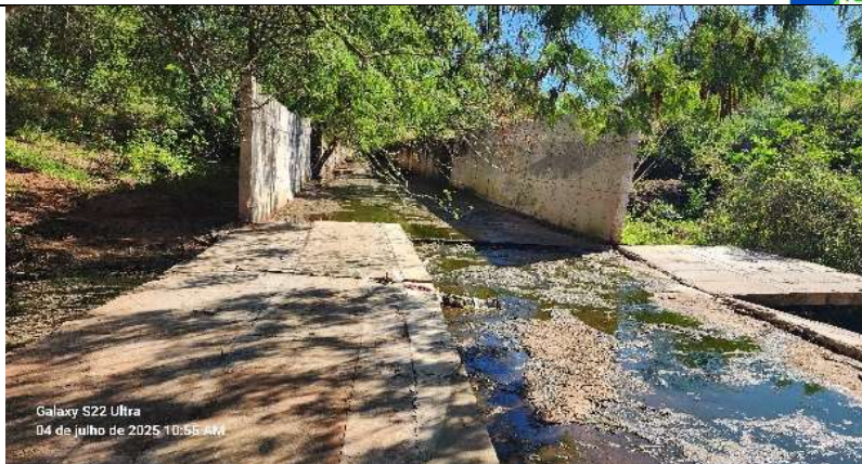
Figura 6 – Vista do final da canalização aberta do córrego do Alegrete Fonte: próprio autor
