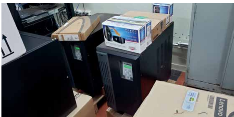
Figura 15: Data Center da PMJ
