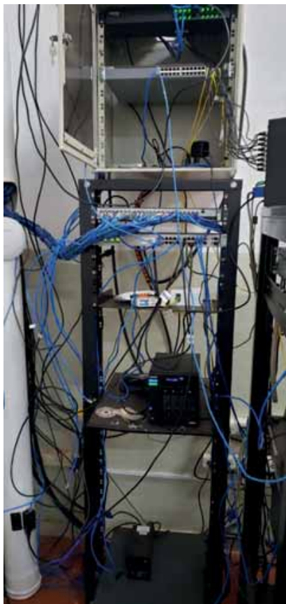
Figura 16: Data Center da PMJ
