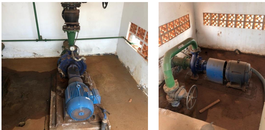
Figura 50: Situação atual de algumas das EEAT existentes no Distrito Sede de Olímpia
