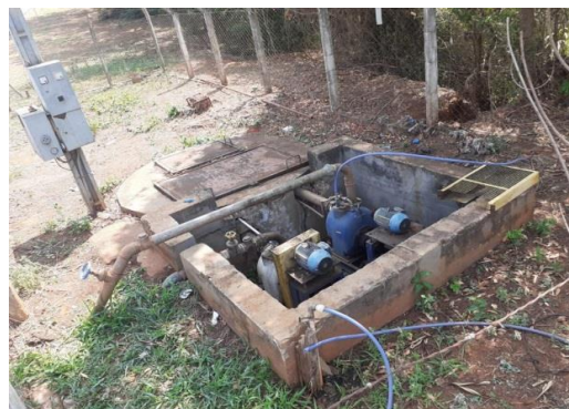
Figura 61: Conjuntos motobombas da EEE do Tropical
