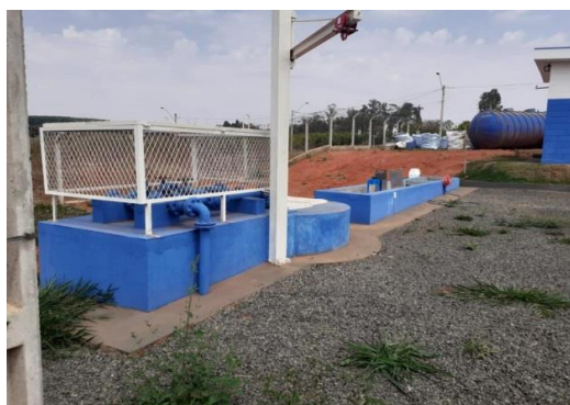
Figura 68: Vista da estrutura física e das instalações da ETE do Jardim Botânico
