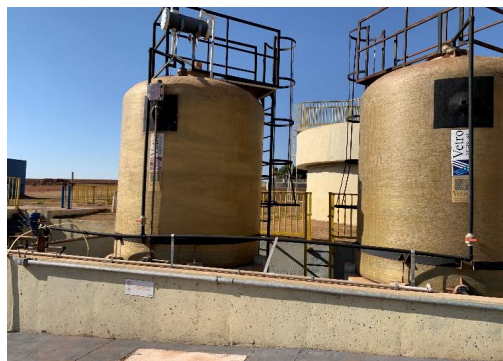
Figura 85: Tanque de produtos químicos
