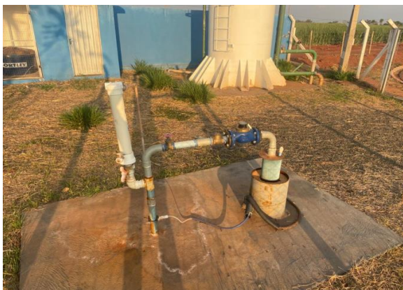
Figura 30: Poço P-95, que junto com os Poços P-41 e P-77 abastecem o Distrito de Ribeiro dos Santos
