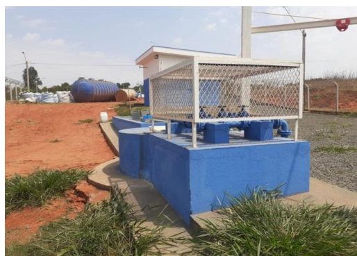
Figura 69: Detalhe da estrutura física e das instalações da ETE do Jardim Botânico
