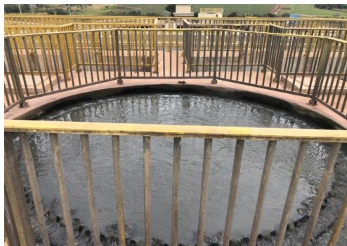
Figura 90: Detalhe dos Reatores Anaeróbios
