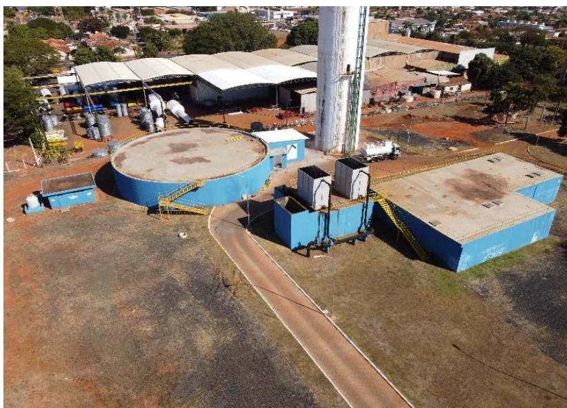
Figura 43: Reservatórios e Torre de Resfriamento
