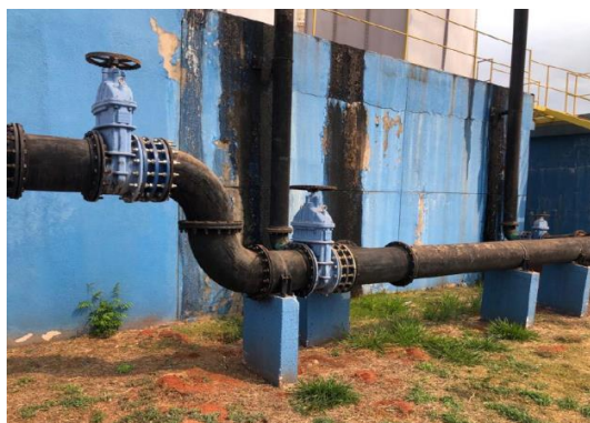
Figura 47: Detalhe dos problemas estruturais no módulo de tratamento que funciona com reservatório
