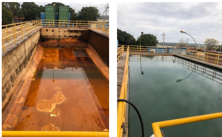
Figura 35: Decantadores da ETA-1
