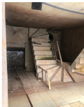
Figura 73: Vista do interior do poço de sucção da EEE Final
