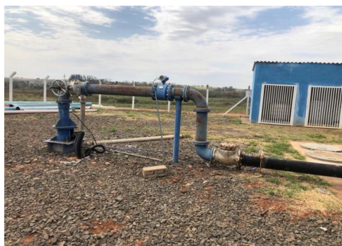
Figura 25: Vista do Poço Profundo PP-02
