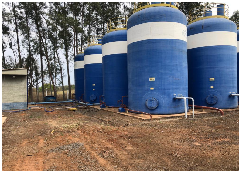
Figura 81: Vista dos módulos UASB e FAS da ECTE Córrego dos Pretos
