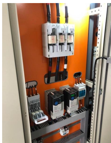
Figura 41: Vista de um dos painéis elétricos da ETA-1
