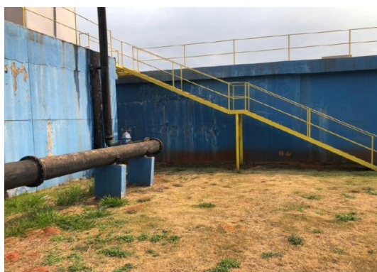
Figura 46: Detalhe das trincas e fissuras com vazamentos existentes nas unidades
