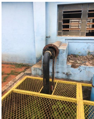
Figura 20: Vista da tubulação de recalque de uma das bombas submersíveis
