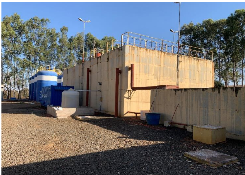
Figura 78: Vista geral da ETE
