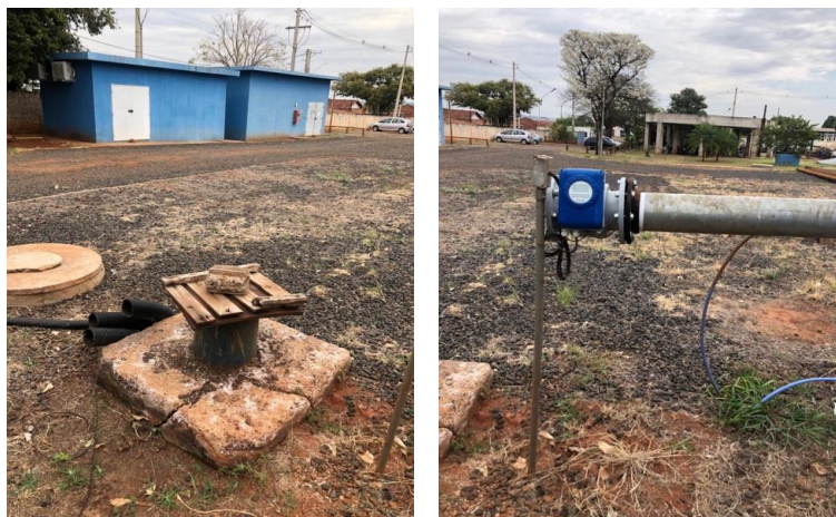
Figura 23: Poço Profundo PP-01 - Localizado na área da ETA-01
