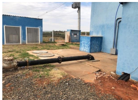
Figura 26: Entrada da tubulação de recalque do Poço Profundo PP-01 no poço de sucção da Estação Elevatória
