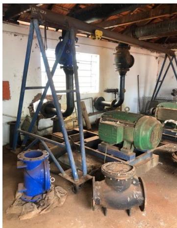
Figura 21: Vista dos motores dos 2 conjuntos motobombas de eixo horizontal desativados
