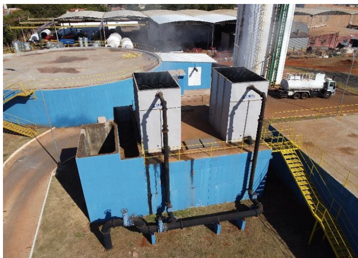
Figura 44: Detalhe da torre resfriamento
