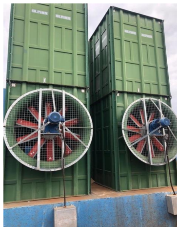
Figura 39: Torres de resfriamento da ETA-1
