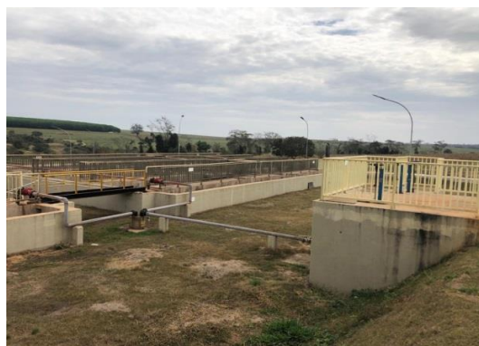
Figura 89: Vista geral dos Reatores Anaeróbios
