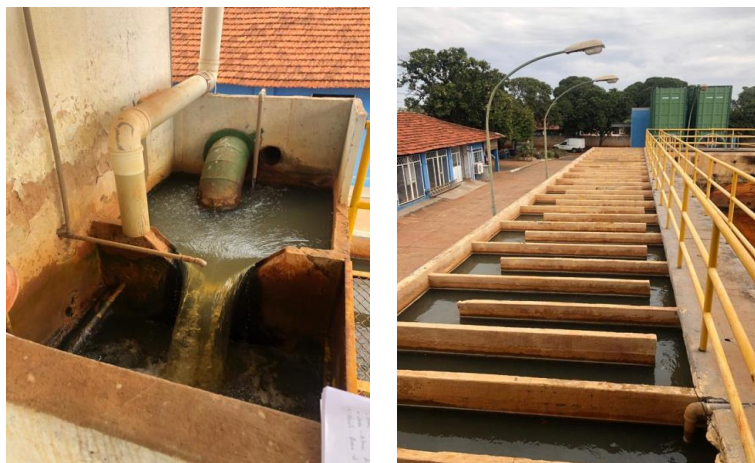
Figura 33: Chegada de água bruta na ETA-1
