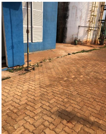
Figura 45: Detalhe do recalque do terreno no entorno das unidades
