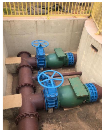
Figura 71: Detalhe da tubulação de recalque da EEE Final
