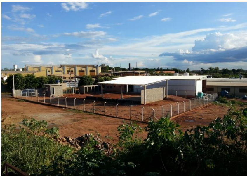
Figura 107: Vista geral do Ecoponto-1
