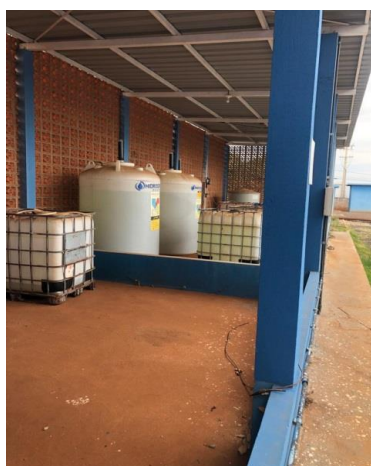
Figura 40: Estocagem de produtos químicos da ETA-1
