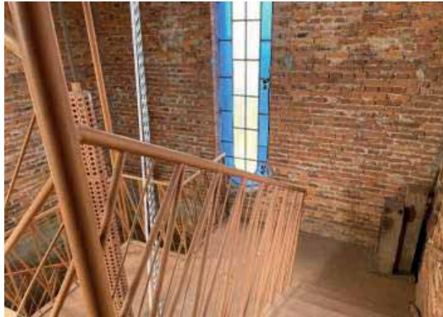
Escada que dá acesso ao 5º pavimento onde se encontram os sinos
