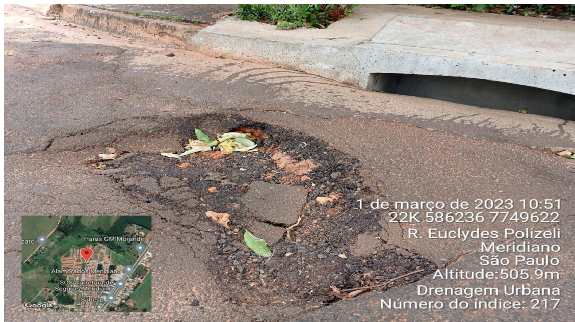
Figura 1: Ruptura e afundamento do asfalto;
