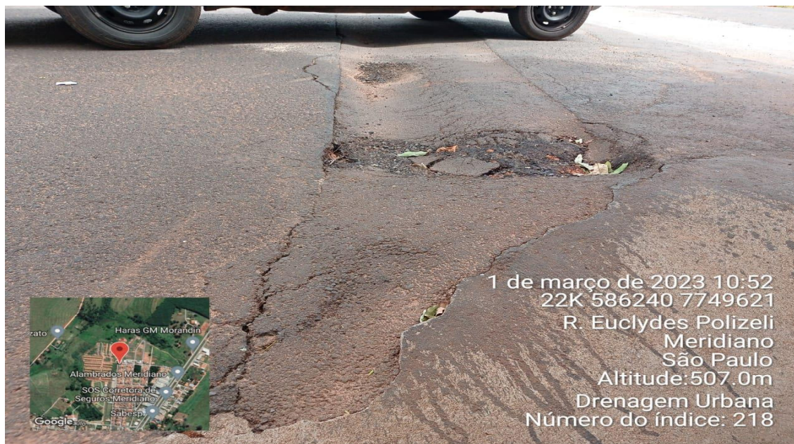
Figura 2: Recalque da vala escavada e asfalto;
