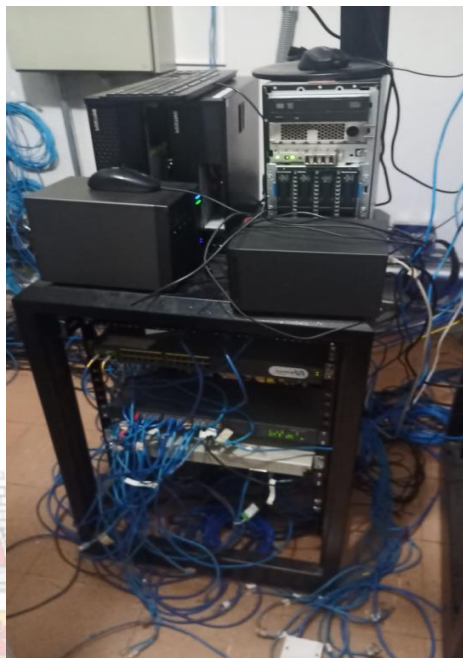
Figura 15: Data Center - PMETO
