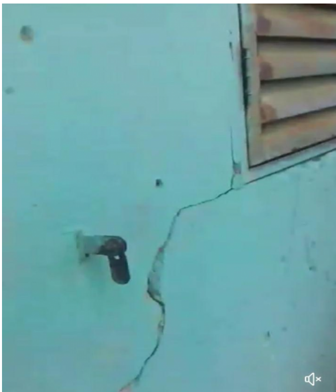
APÓS A ENXORRADA APRESENTOU TRINCAS EM RESIDENCIA
