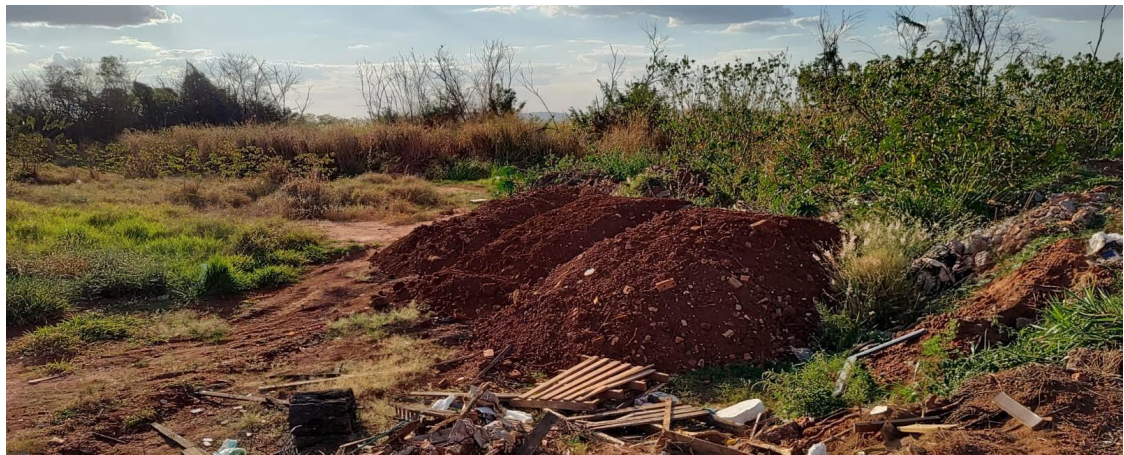
Imagem 21 – Resíduos da Construção Civil dispostos em área de transbordo. Fonte: eBio, 2023.
