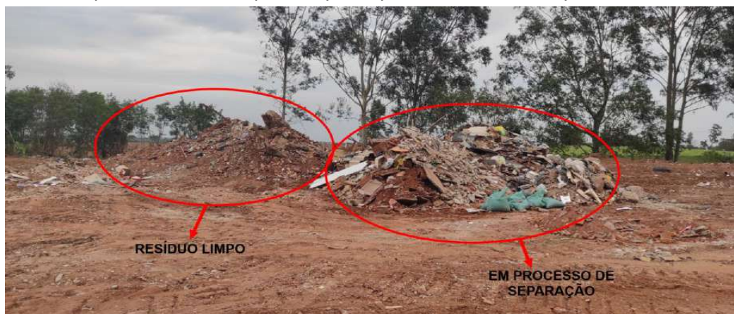
Figura 26: Material em fase de triagem, separação dos resíduos “sujos” para o resíduo limpo, composto predominantemente por RCC.
