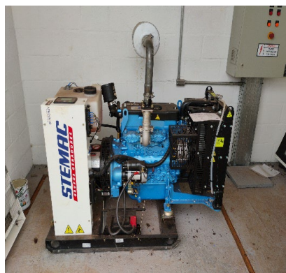
EEE BELAS ARTES II - GERADOR DE ENERGIA
