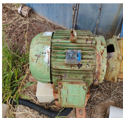
RESERVATORIO R13 - CONJUNTO MOTOBOMBA CENTRIFUGA
