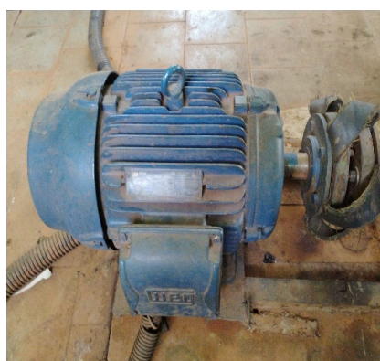
RESERVATORIO R1 - CONJUNTO MOTOBOMBA CENTRIFUGA
