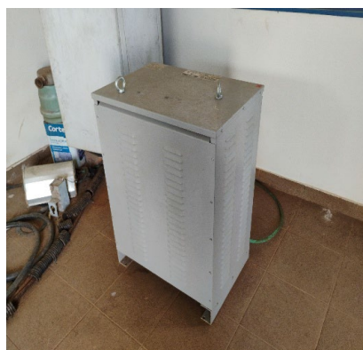
RESERVATORIO R12 - TRANSFORMADOR
