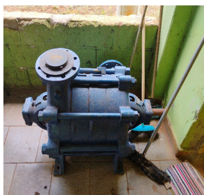
RESERVATORIO R1 - CONJUNTO MOTOBOMBA CENTRIFUGA
