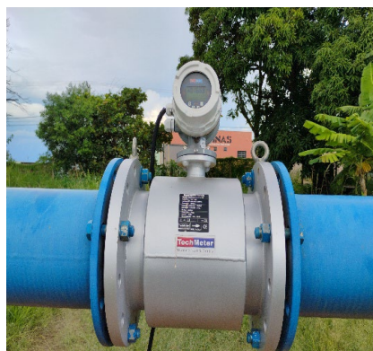
POCO DISTRITO INDUSTRIAL - MEDIDOR DE VAZAO
