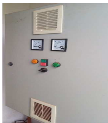
POÇO FORTALEZA – PAINEL ELÉTRICO
