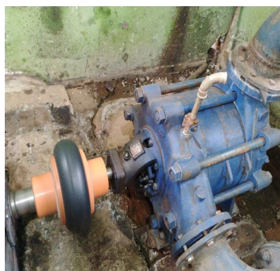
RESERVATORIO R1 - CONJUNTO MOTOBOMBA CENTRIFUGA
