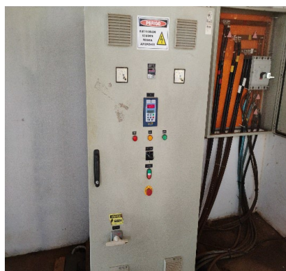
POCO DISTRITO INDUSTRIAL - PAINEL ELETRICO
