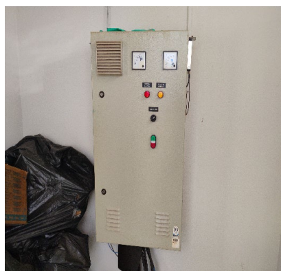
POCO JARDIM MIRANDA - PAINEL ELETRICO
