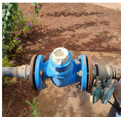
POCO COHAB II.II - MEDIDOR DE VAZAO
