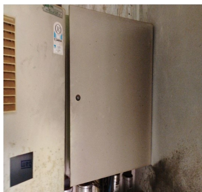
POCO CONTENDAS I - BANCO CAPACITOR
