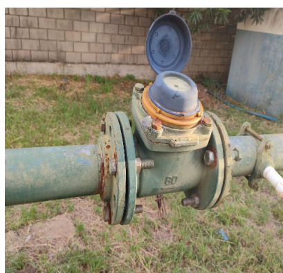
POCO QUEBEC - MEDIDOR DE VAZAO
