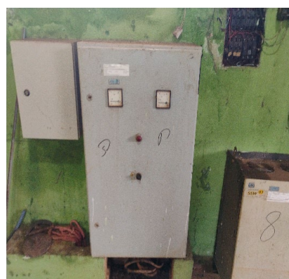
POCO CONTENDAS II - PAINEL ELETRICO
