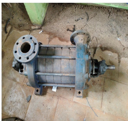
RESERVATORIO R1 - CONJUNTO MOTOBOMBA CENTRIFUGA
