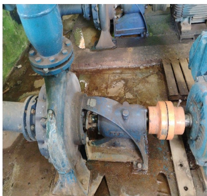
RESERVATORIO R1 - CONJUNTO MOTOBOMBA CENTRIFUGA
