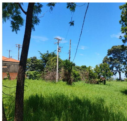
POCO CASA BRANCA - TRANSFORMADOR
