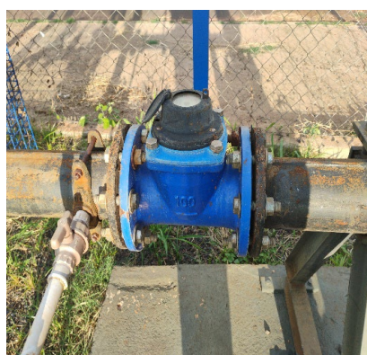
POCO JARDIM MIRANDA - MEDIDOR DE VAZAO
