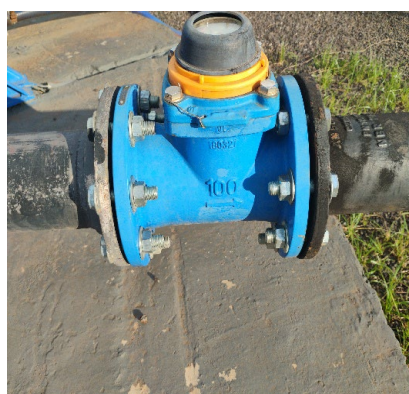
RESERVATORIO R15 - MEDIDOR DE VAZAO
