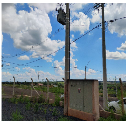
POCO BELAS ARTES - TRANSFORMADOR
