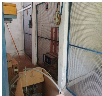
POCO CONTENDAS I - DISJUNTOR GERAL
