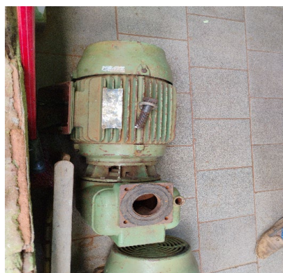
RESERVATORIO R1 - CONJUNTO MOTOBOMBA CENTRIFUGA
