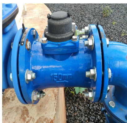
RESERVATORIO R19 - MEDIDOR DE VAZAO
