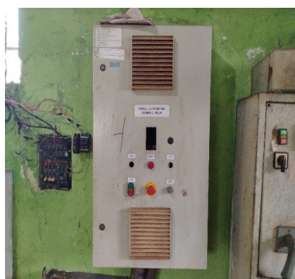
POCO CONTENDAS II - PAINEL ELETRICO
