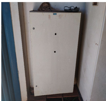
POCO CASA BRANCA - BANCO CAPACITOR
