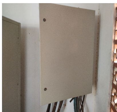
POCO DISTRITO INDUSTRIAL - PAINEL ELETRICO
