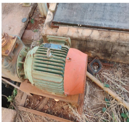
EEE VERONA - CONJUNTO MOTOBOMBA CENTRIFUGA
