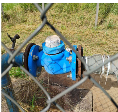
POCO COHAB II - MEDIDOR DE VAZAO
