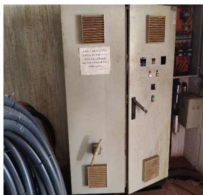
POCO CONTENDAS I - PAINEL ELETRICO
