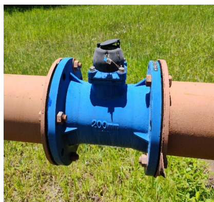
POCO CONTENDAS I - MEDIDOR DE VAZAO
