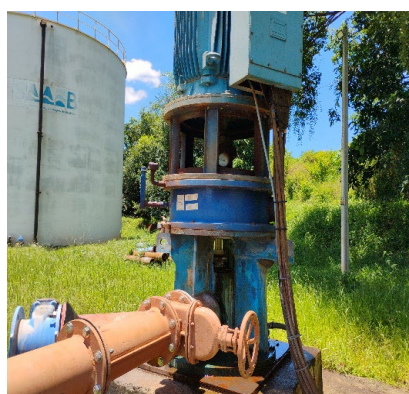
POCO CONTENDAS I - CONJUNTO MOTOBOMBA CENTRIFUGA
