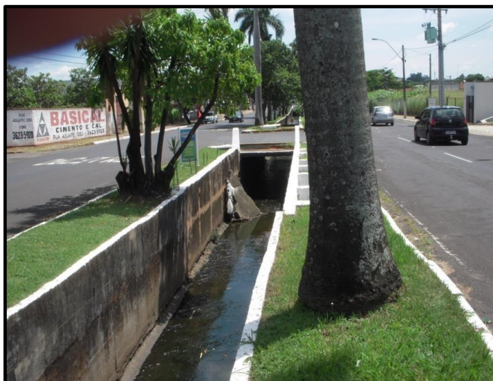
Córrego Machado de Melo – Av. João Arruda Brasil Seção insuficiente – Sugere-se galeria de reforço sob uma das pistas Melhorar estabilidade dos muros laterais do canal
