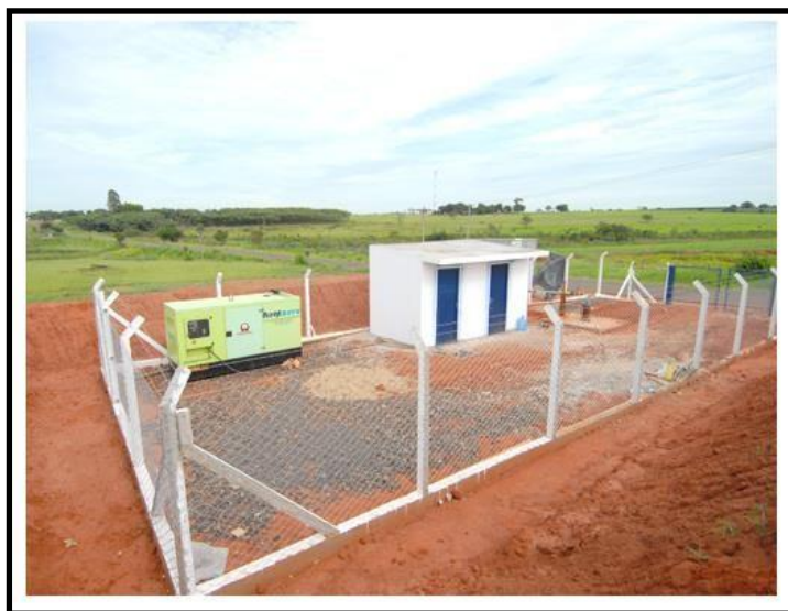
Sistemas isolados de poços profundos Poço Taveira – 2018
