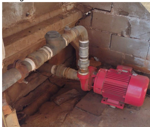
Figura 70: Bomba de abastecimento.
