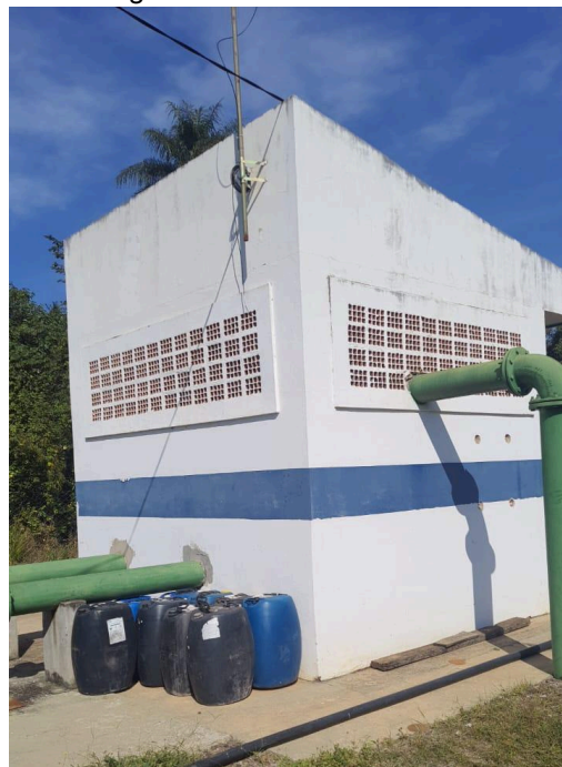
Figura 89: Casa de bombas.
