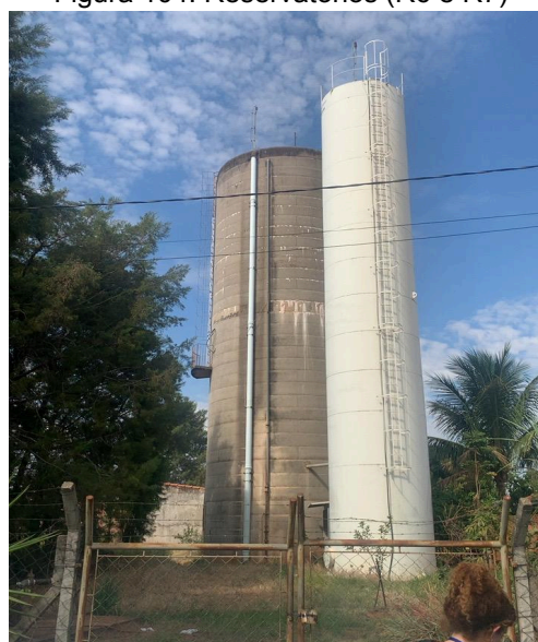
Figura 104: Reservatórios (R6 e R7)
