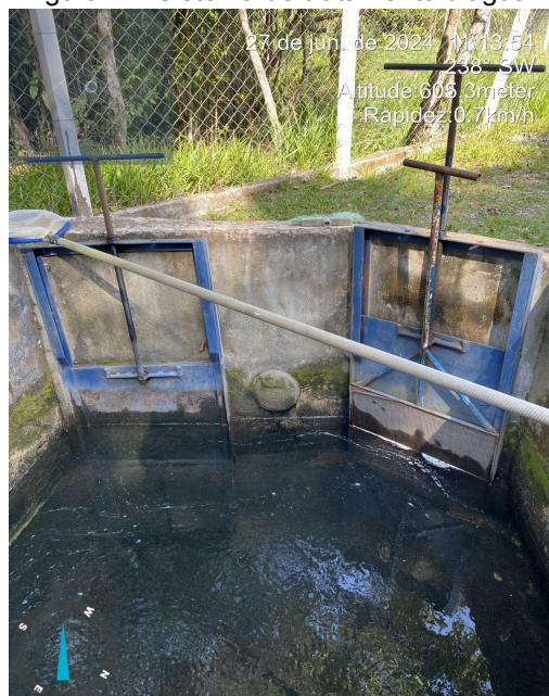
Figura 77: Sistema de tratamento d'água.
