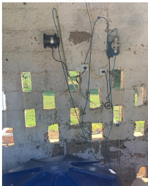
Figura 58: Casa de controle e bombeamento.
