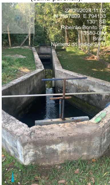
Figura 78: Sistema de tratamento d'água (calha parshall).
