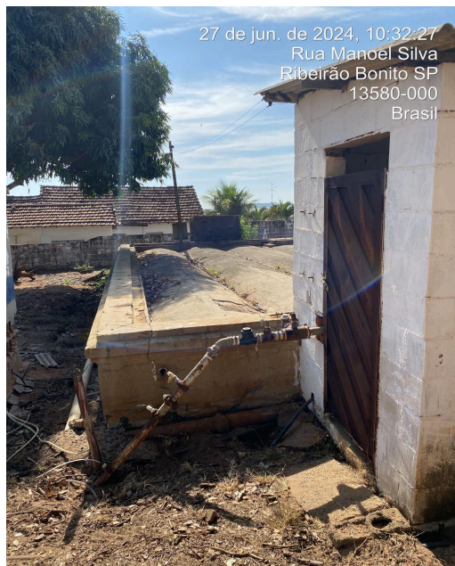
Figura 64: Casa de bombeamento.
