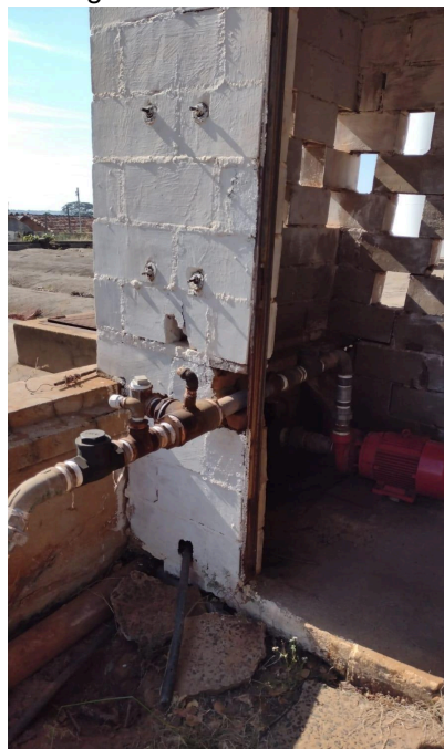
Figura 66: Casa de bombeamento.
