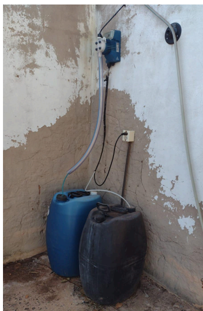
Figura 67: Casa de cloração e fluoretação.
