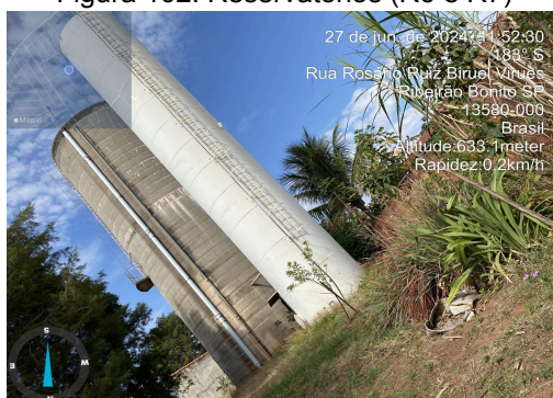
Figura 102: Reservatórios (R6 e R7)
