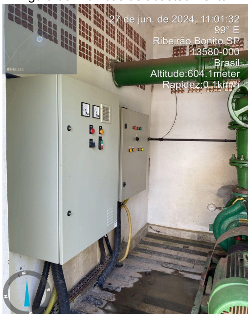
Figura 90: Bombas de abastecimento.
