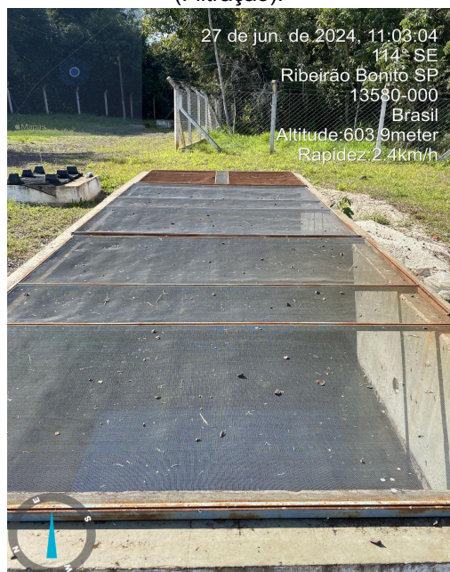
Figura 81: Sistema de tratamento d'água (Filtração).
