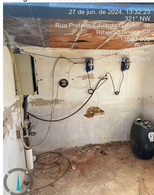
Figura 111: Casa de bombeamento.
